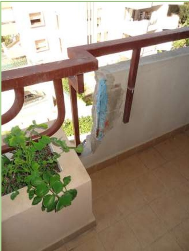
Foto n° 42: Difettosità nel parapetto del balcone 4
