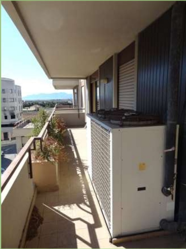
Foto n° 34: Balcone 1 (particolare U.E. pompa di calore)
