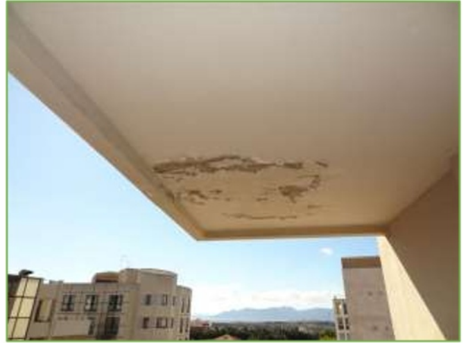
Foto n° 37: Infiltrazioni soffitto Balcone 2
