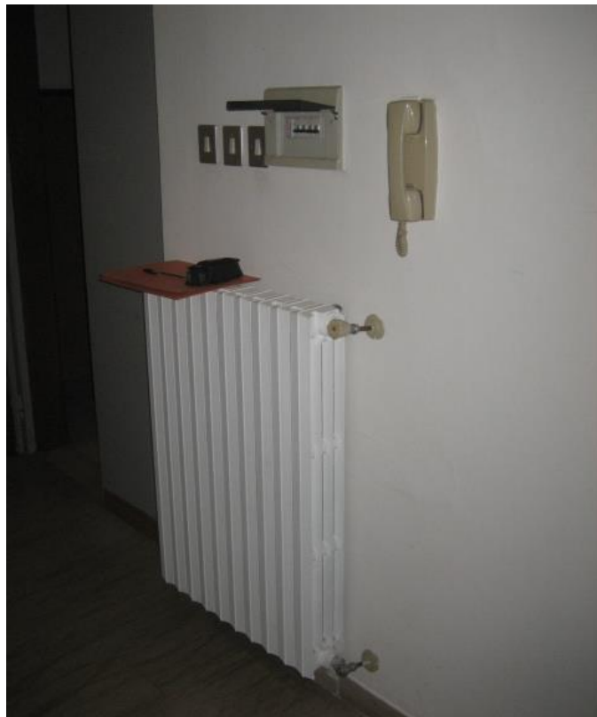
FOTO n. 10 – Tipologia termosifoni, placche luci e quadro elettrico appartamento.
