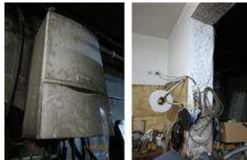
Particolare caldaia installata nel locale abusivo - Particolare taglio muro in calcestruzzo per accesso al locale abusivo
