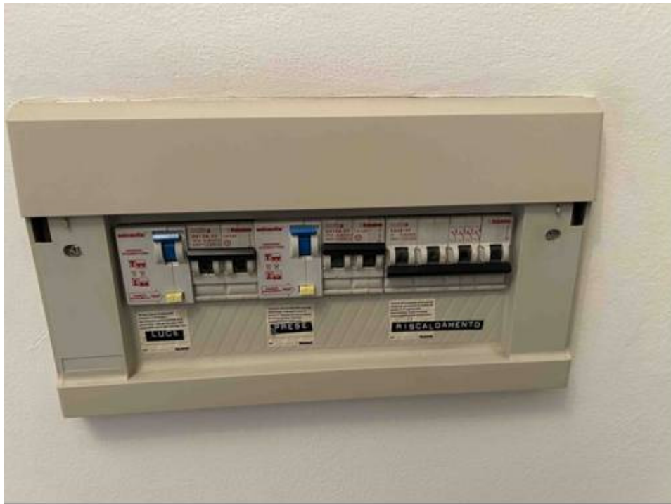
Foto n° 29 – Foto scattata al quadro elettrico generale posto all'ingresso dell'appartamento, dotato di dispositivo magneto-termico (salva-vita).
