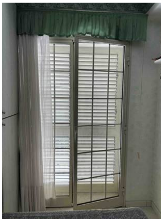
Foto n° 32 – Foto scattata all'interno di una cameretta. E' presente l'infisso in alluminio pre-verniciato dello spessore di 4 cm dotato di vetrocamera e ed è visibile l'infisso esterno alla veneziana.
