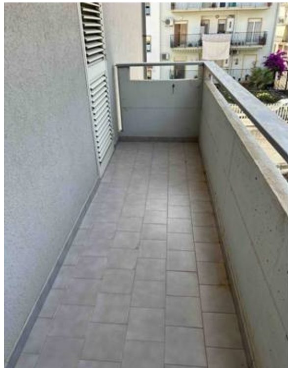
Foto n° 52 – Altra foto scattata nel ballatoio esposto a sud-ovest. La pavimentazione è in gres per esterni e la ringhiera è in calcestruzzo.
