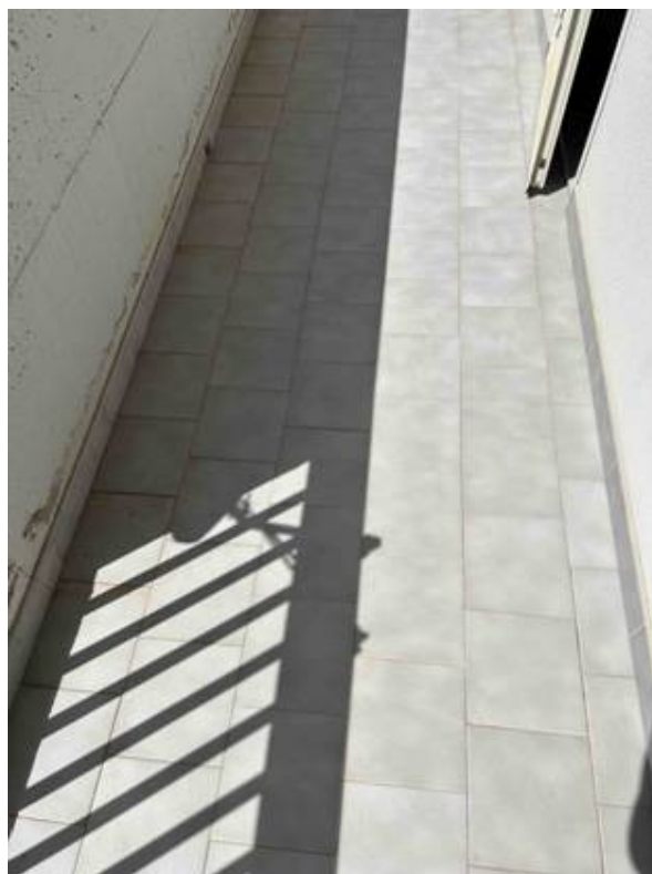
Foto n° 50 – Altra foto scattata nel ballatoio esposto a sud-est. La pavimentazione è in gres per esterni e la ringhiera è in alcuni tratti in ferro pieno ed in altri in calcestruzzo.
