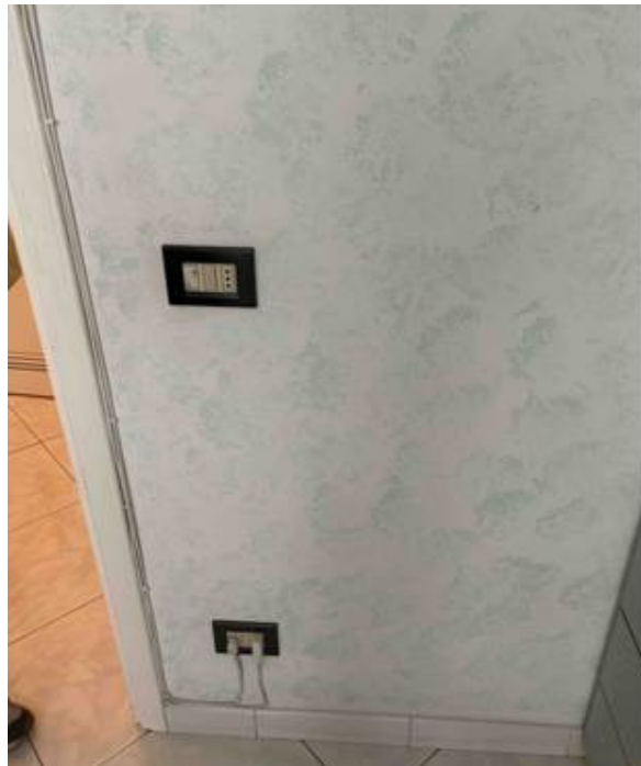
Foto n° 35 – Foto scattata alla parete tinteggiate con la tecnica dello spatolato. L'impianto elettrico sottotraccia è funzionante ed è a norma. Sono però presenti dei cavi esterni posizionati lungo la parete senza le apposite canalette e quindi non a norma con le vigenti leggi in materia.
