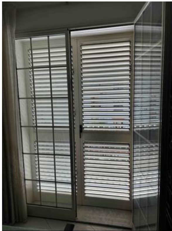
Foto n° 22 – Foto scattata all'infisso interno a due ante in alluminio pre-verniciato dello spessore di 4 cm con vetrocamera. E' inoltre presente un infisso esterno alla veneziana.
