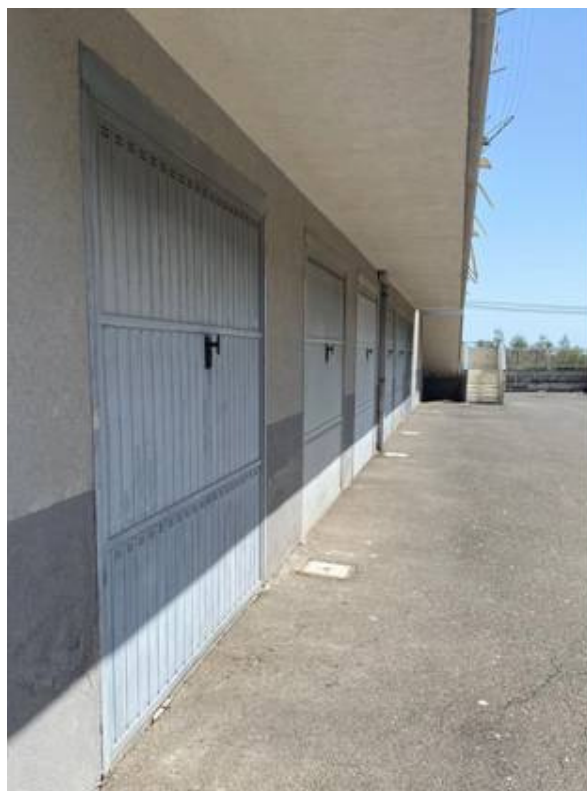
Foto n° 13 – Prospetto interno. Foto scattata alle porte basculanti dei garages/box. La pavimentazione del cortile interno è in conglomerato bituminoso.
