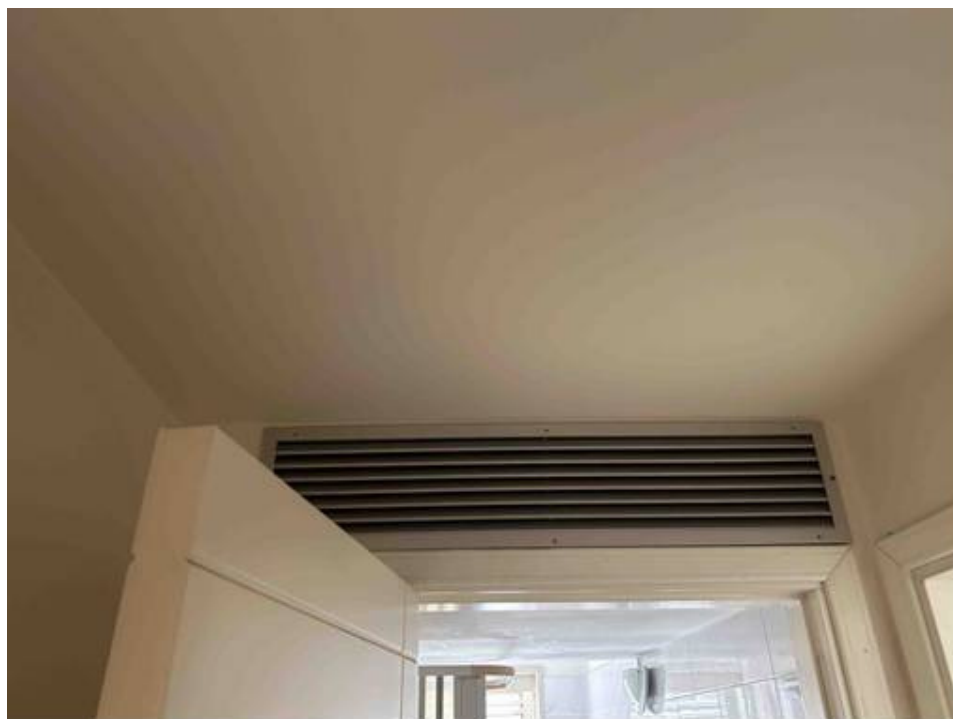
Foto n° 42 – Foto scattata nel soffitto del disimpegno. Si evidenzia la griglia per la climatizzazione estiva ed invernale.
