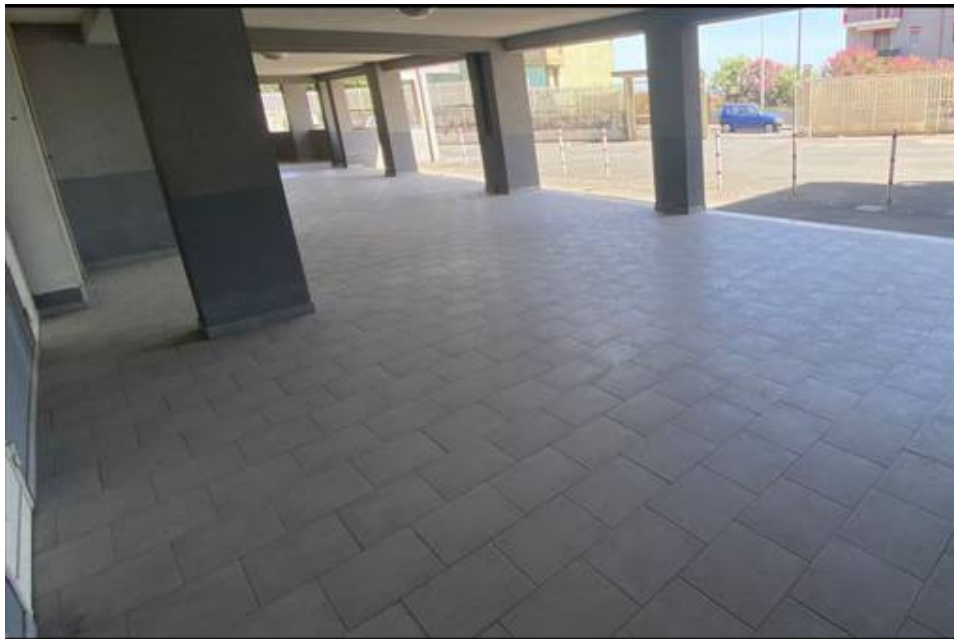
Foto n° 10 – Altra vista del portico interno. Lo stesso risulta pavimentato con gres porcellanato antigelo ed antiscivolo e delimitato da paletti in ferro pieno di colore bianco/rosso.
