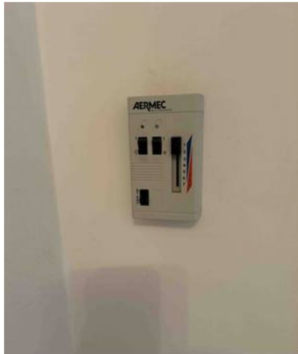
Foto n° 43 – Foto scattata al cronotermostato posto nel disimpegno e che ha la funzione di attivare e regolare l’impianto di climatizzazione.
