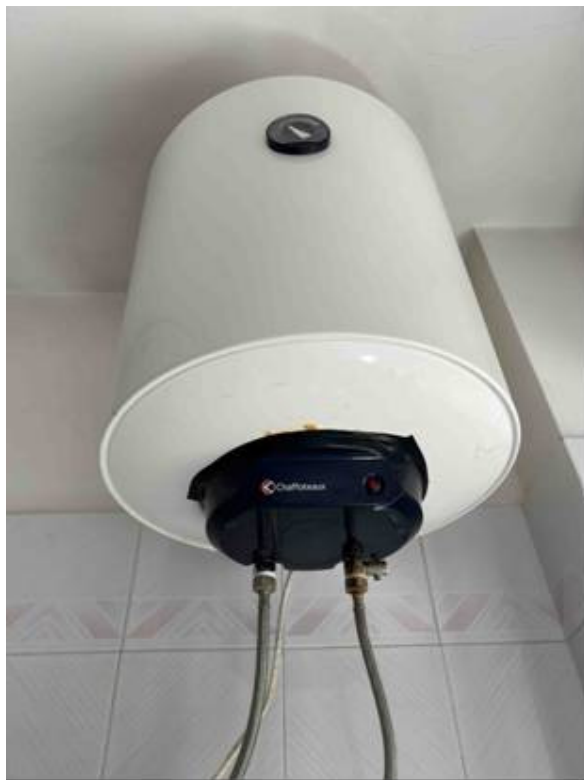
Foto n° 46 – Foto scattata allo scaldacqua marca Chaffoteaux di 50 litri.
