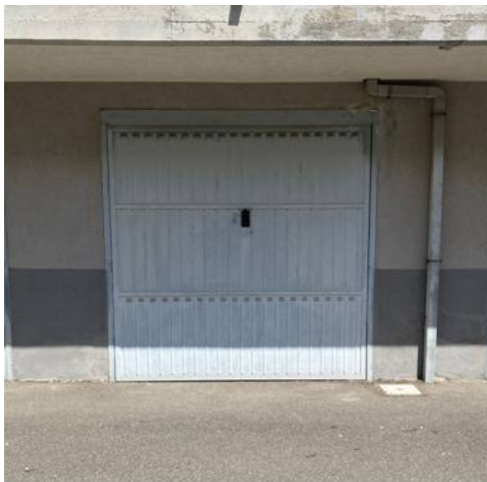
Foto n° 14 – Foto scattata alla porta basculante del garage/box oggetto dell'esecuzione.
