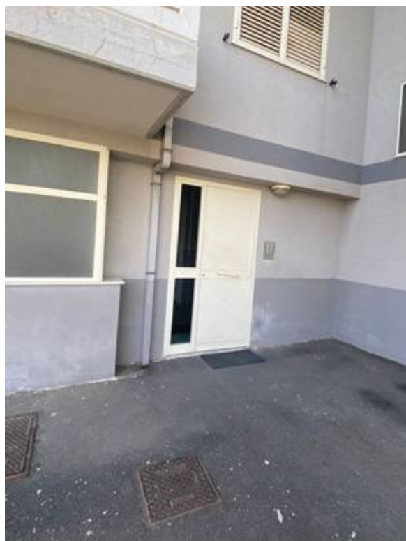
Foto n° 11 – Foto scattata al portone di ingresso della scala B. Lo stesso è stato realizzato in alluminio anodizzato con vetro laterale. La pavimentazione, in corrispondenza del portone della scala B, è in conglomerato bituminoso e si presenta in buone condizioni.
