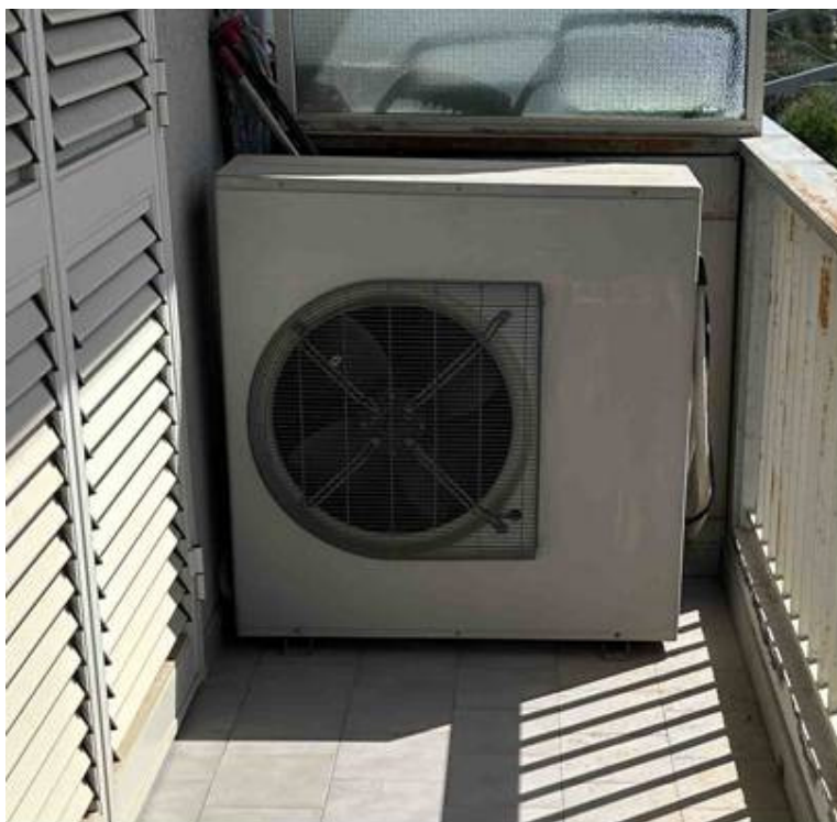
Foto n° 49 – Foto scattata alla macchina termica per la climatizzazione estiva ed invernale.
