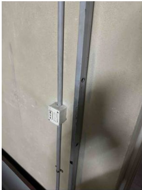
Foto n° 60 – Foto scattata alla tubazione esterna dell'impianto di illuminazione del garage – a norma.
