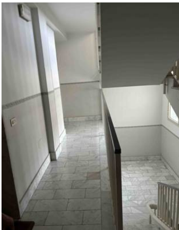
Foto n° 18 – Altra foto al pianerottolo del secondo piano. La pavimentazione è in marmo bianco mentre le pareti sono intonacate e tinteggiate con idropittura e la ringhiera è in ferro.
