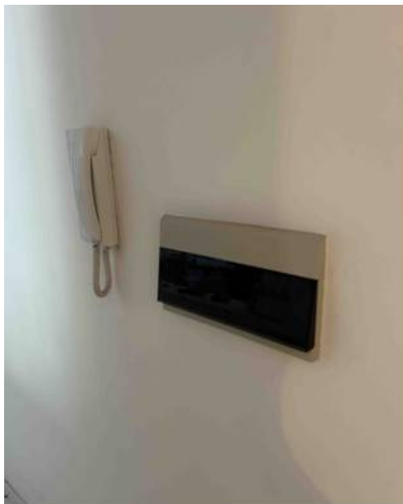
Foto n° 28 – Foto scattata al quadro elettrico generale posto all'ingresso dell'appartamento ed al citofono interno. L'impianto è a norma.
