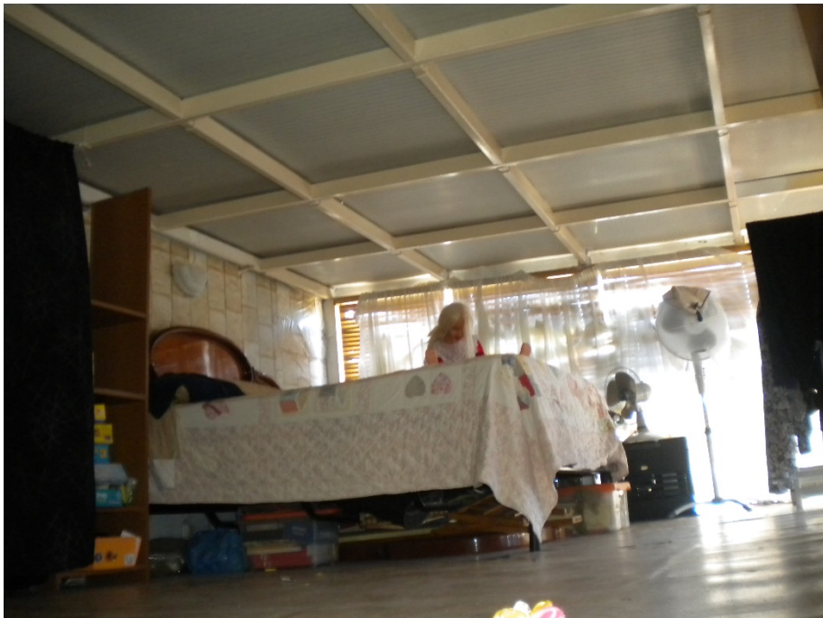
Foto 16 – Soffitta-soppalco sup. non res. (adibito impropriamente a camera da letto)
