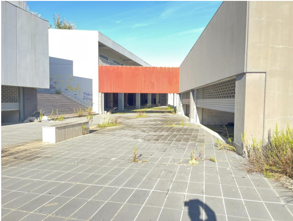
Fotografia n.10 – Piano Terra – Il piazzale esterno di collegamento. Sullo sfondo il blocco destinato al Supermercato ed, alla destra del fotogramma quello dedicato ai Negozi.
