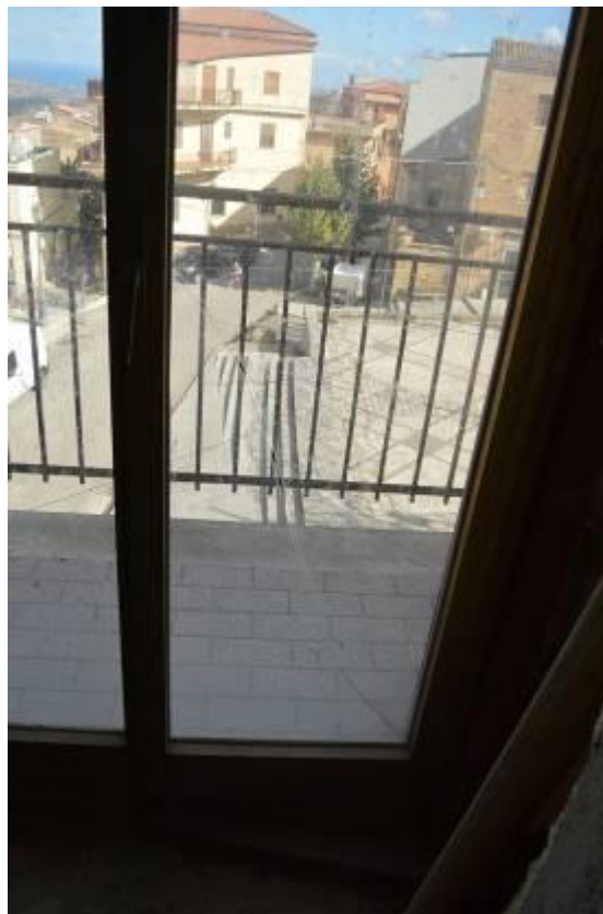
Infissi con vetro rotto
