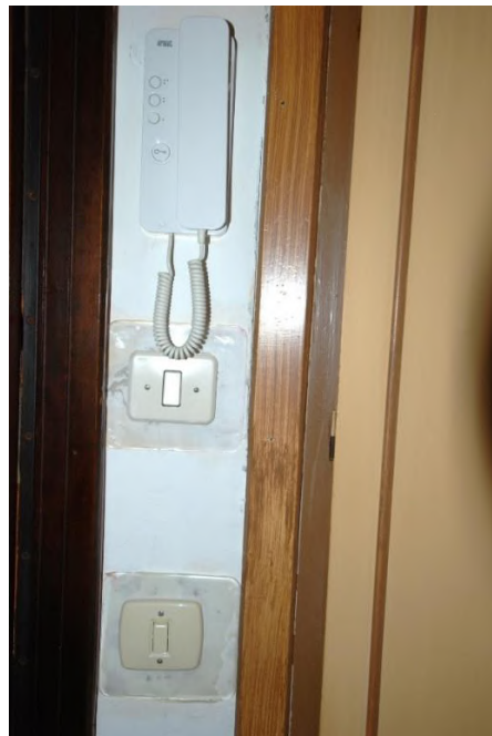
Figura 14. Dettaglio degli interruttori dell'impianto elettrico
