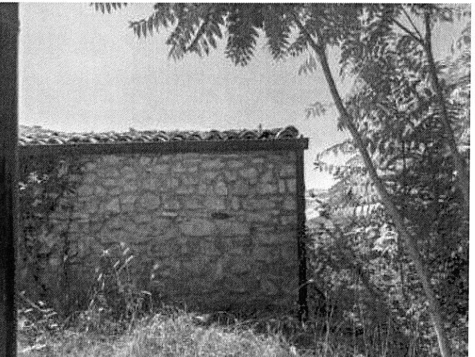
Foto n. 126 – Fabbricato ricadente sulla part. 161
