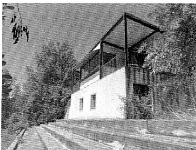
Foto n. 136 – Fabbricato ricadente sulla part. 169
