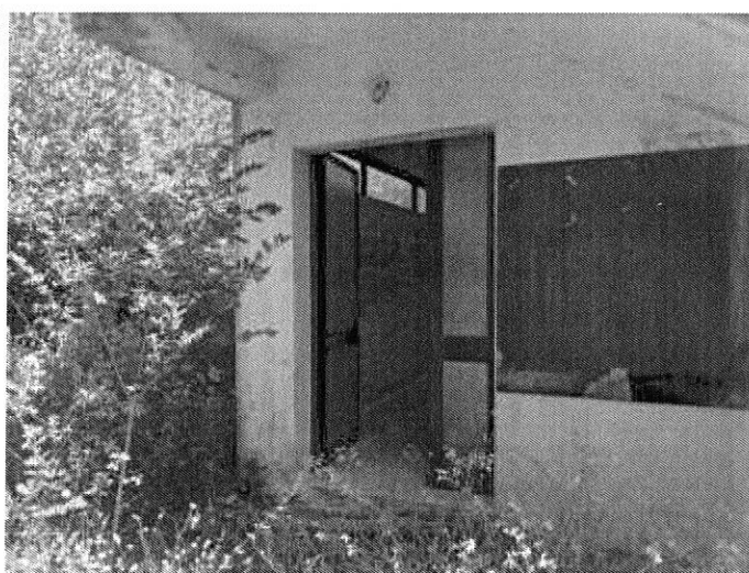
Foto n. 138 – Fabbricato ricadente sulla part. 169
