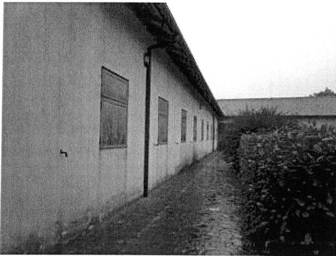
Foto n. 69 – Fabbricato ricadente sulla part. 131
