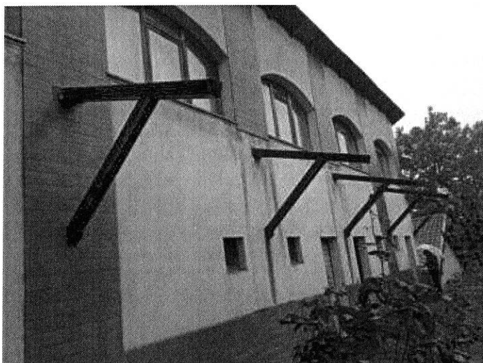
Foto n. 83 – Fabbricato ricadente sulla part. 132
