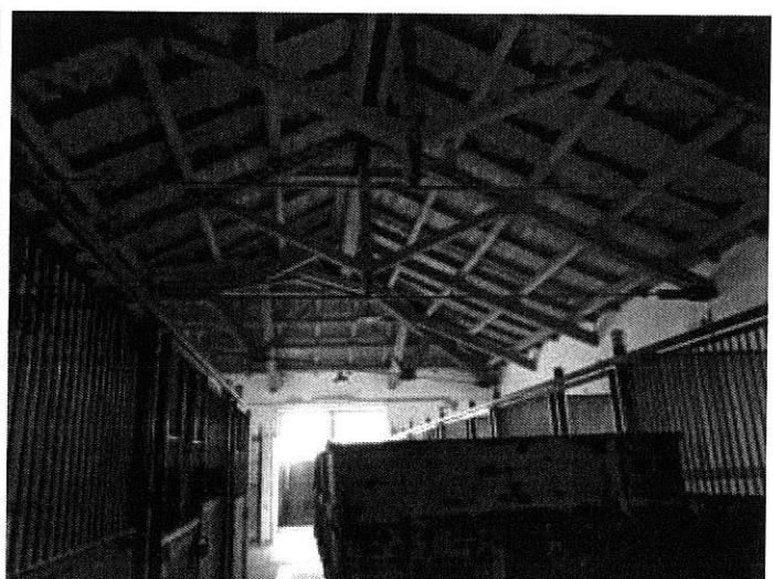
Foto n. 74 – Fabbricato ricadente sulla part. 131
