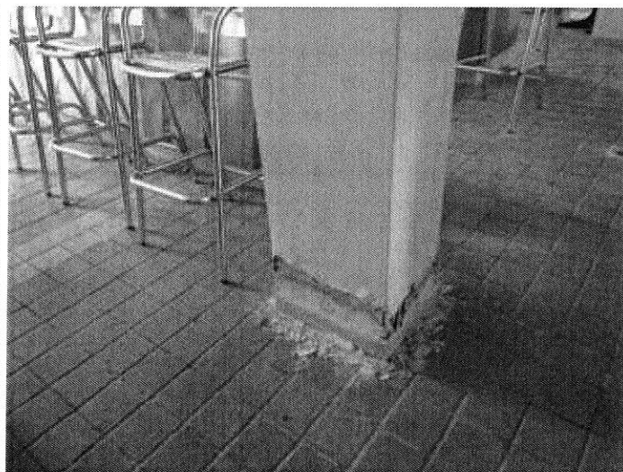
Foto n. 120 – Fabbricato ricadente sulla part. 160
