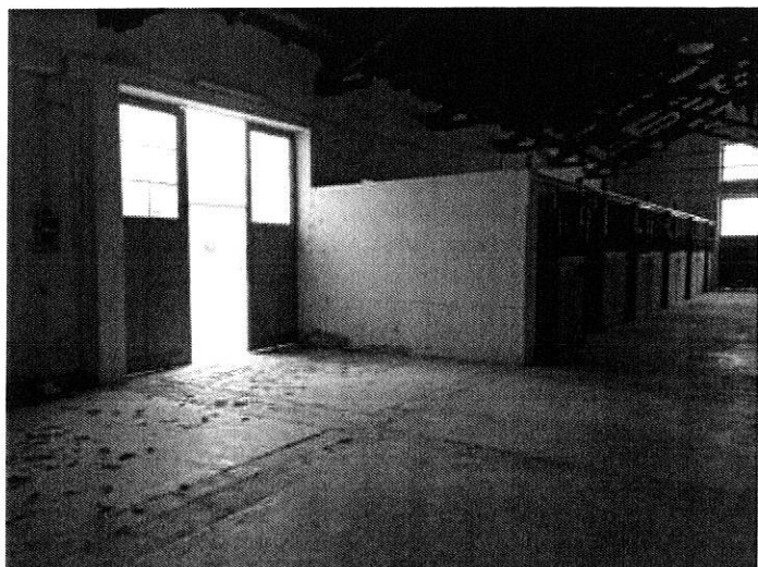
Foto n. 85 – F Fabbricato ricadente sulla part. 132 – piano terra
