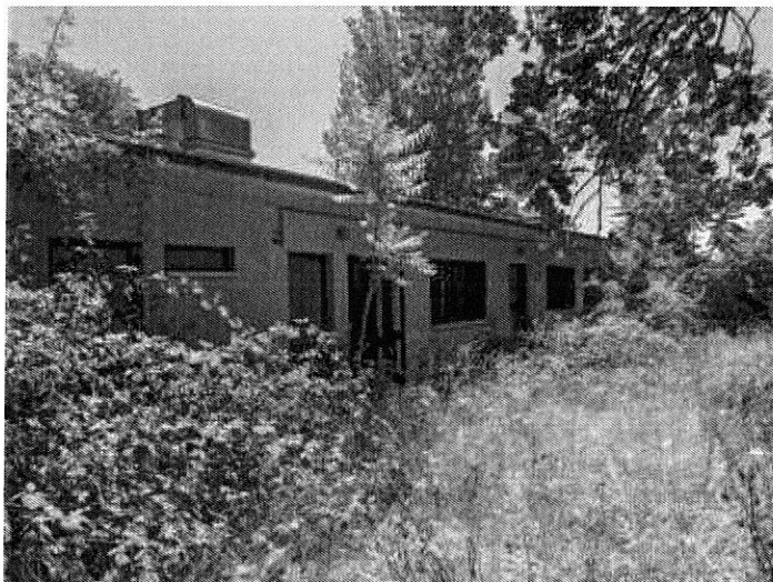
Foto n. 115 – Fabbricato ricadente sulla part. 160
