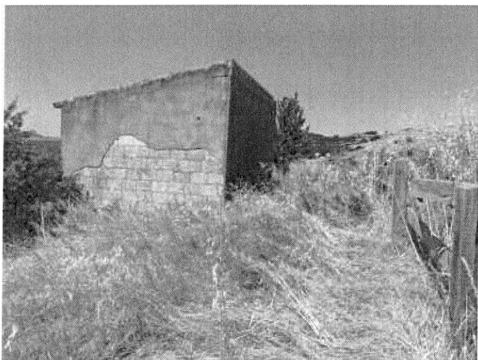
Foto n. 147 – Fabbricato ricadente sulla part. 139
