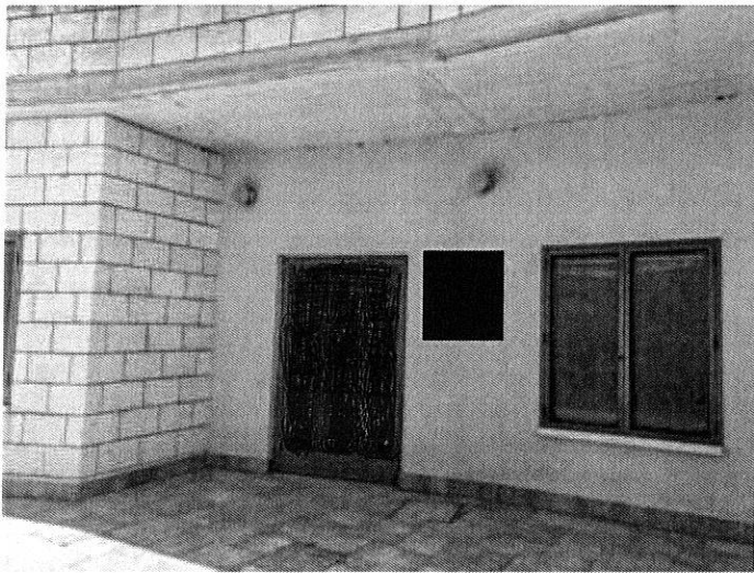
Foto n. 131 – Fabbricato ricadente sulla part. 162
