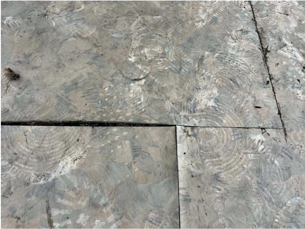
CONDIZIONE PAVIMENTO NEL LOCALE COMMERCIALE
