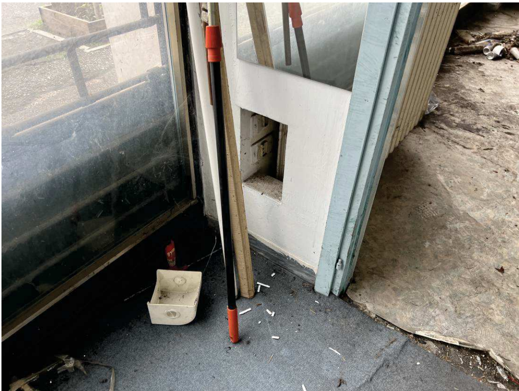
CONDIZIONE PAVIMENTO NEL LOCALE COMMERCIALE
