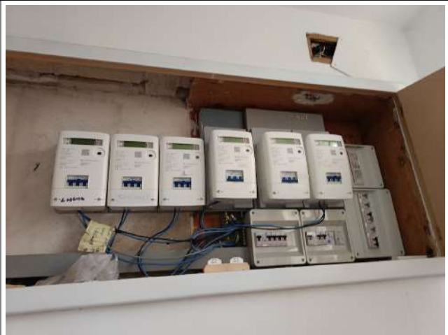
Quadri energia elettrica su scala condominiale
