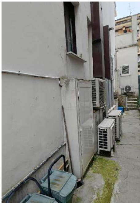
Corte esterna consominiale con quadri gas etc
