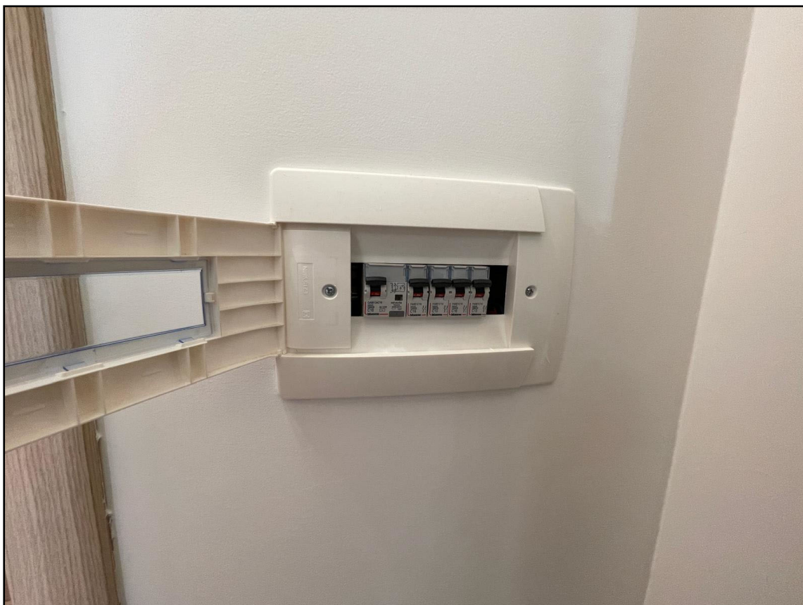
Foto n° 03 – piano terra: quadro elettrico
