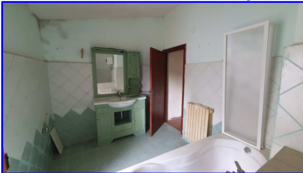
Particolare del bagno con vista dalla finestra verso la porta di accesso
