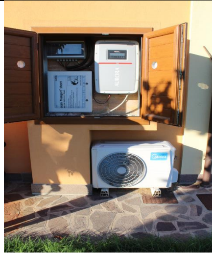
QUADRO ELETTRICO IMPIANTO FOTOVOLTAICO POSTO SULLA COPERTURA DEL CORPO VENDITA PRODOTTI, LABORATORIO E UFFICI
