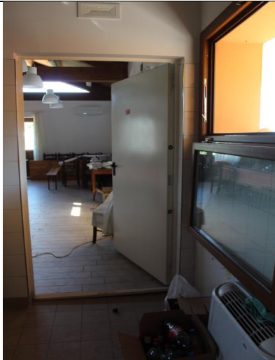
DALLA CUCINA ACCESSO ALLA SALA RISTORANTE (porta tagliafuoco)
