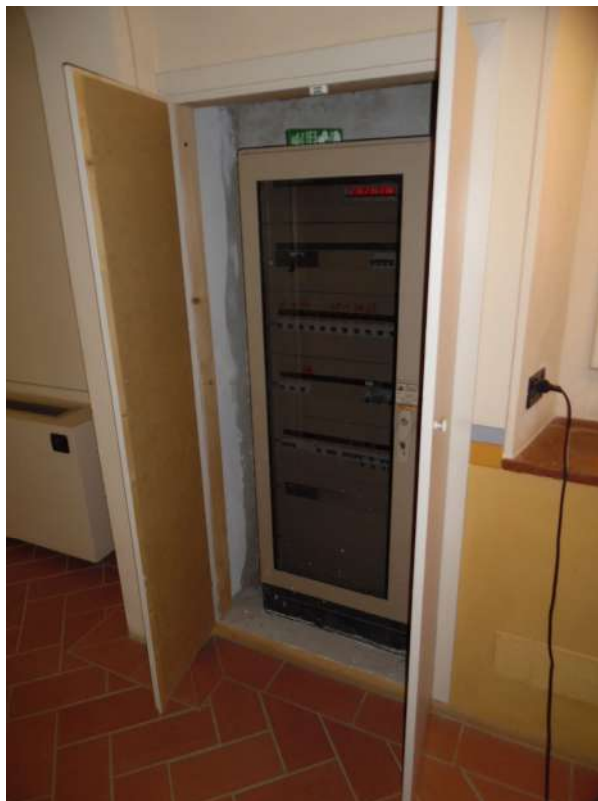
FOTO 35 – Vista quadro elettrico
