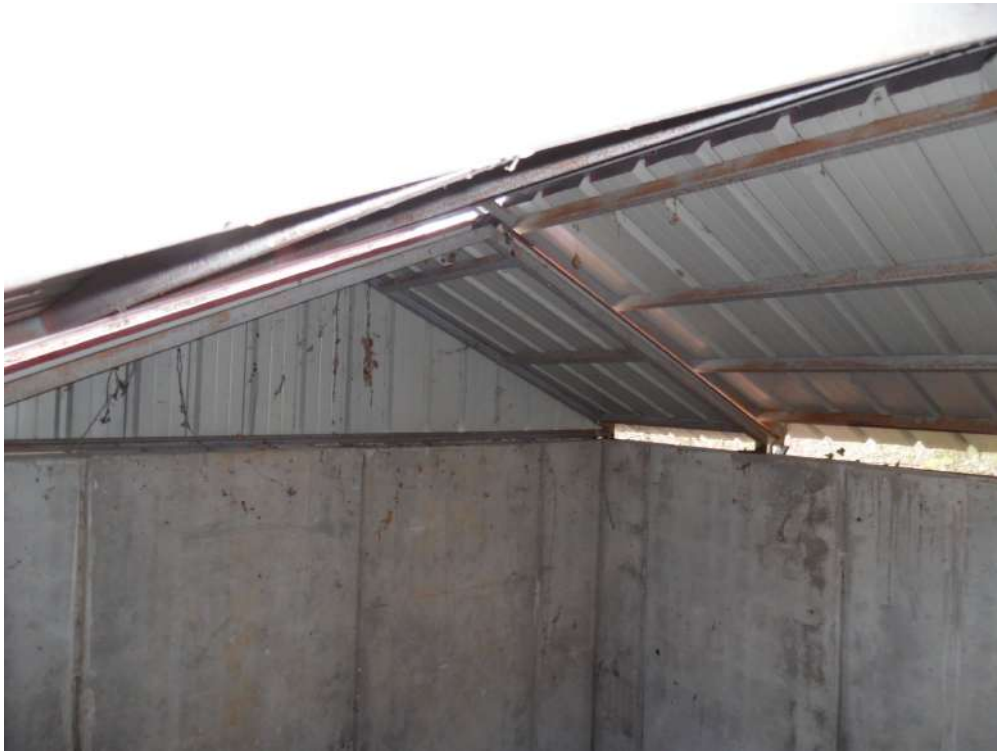
FOTO 17 – Vista silo orizzontali (1)
