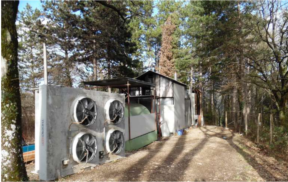
FOTO 7 – Vista esterna generatori (3-4)
