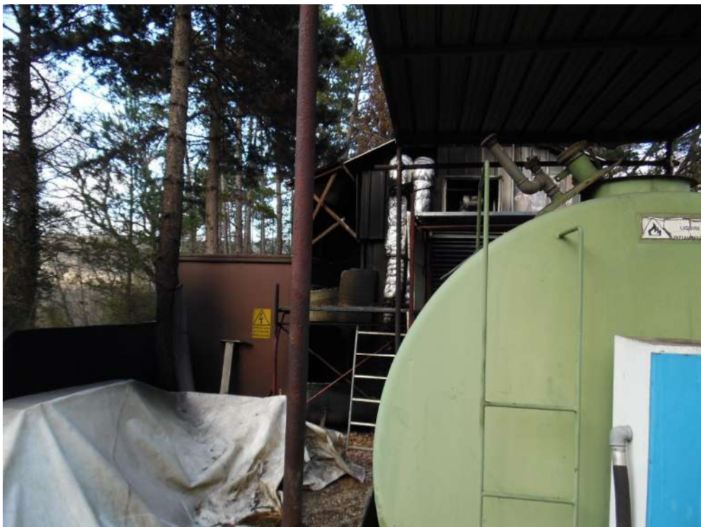
FOTO 22 – Vista locali macchine (3-4-5)
