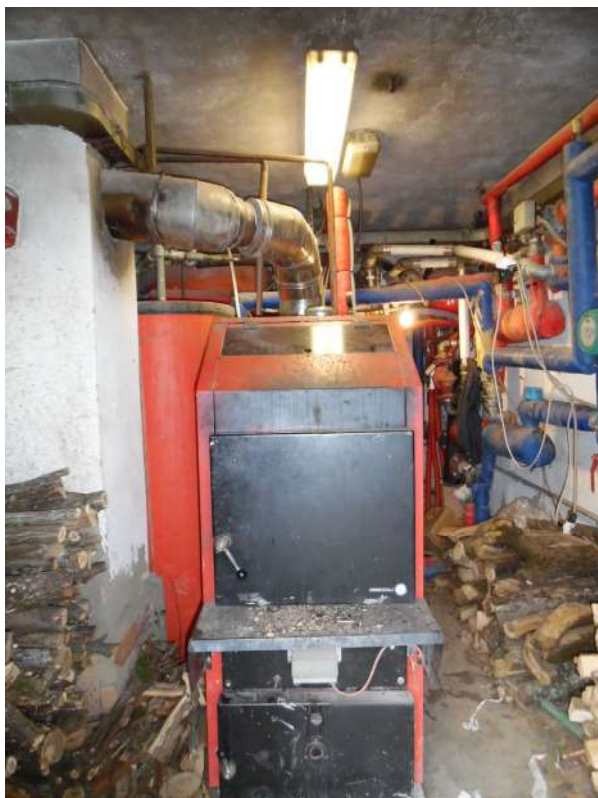
FOTO 157 – Vista centrale termica (31)
