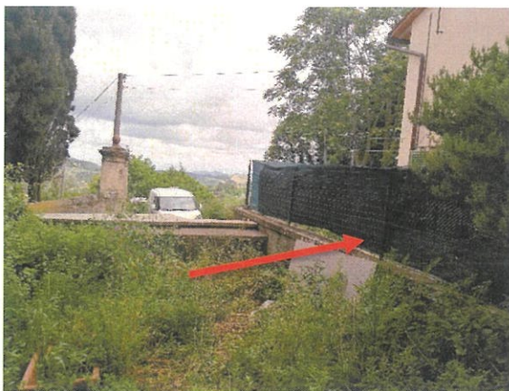
Foto n.6: Muro con rete verde confinante tra part.75 e part.74 graffiata in corrispondenza con i punti n.58 e 81.
