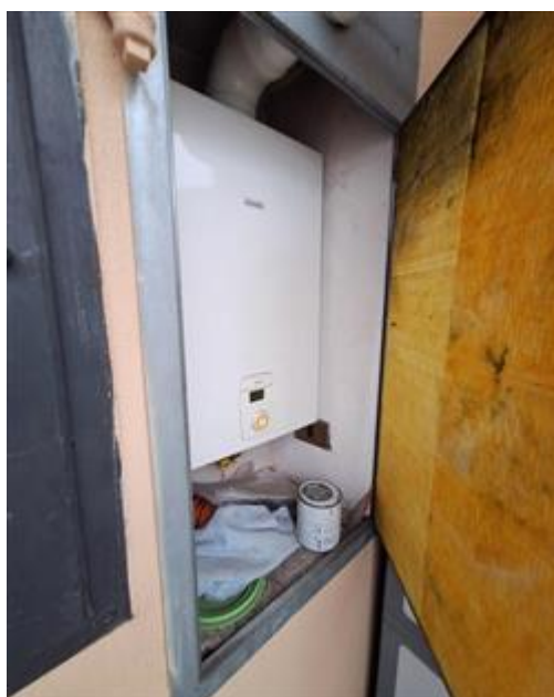
caldaia a gas metano, sul balcone OVEST, per la produzione di acqua calda sanitaria
