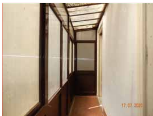
Foto n. 3 – balcone P1° trasformato in veranda
