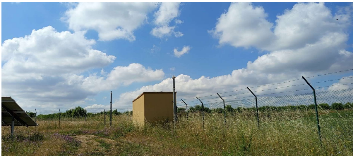
Vista cabina Enel
