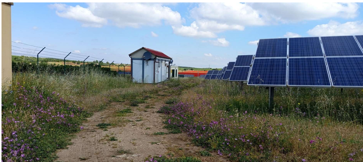
Vista container servizi
