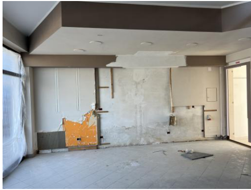
LAVORAZIONI NON COMPLETATE
