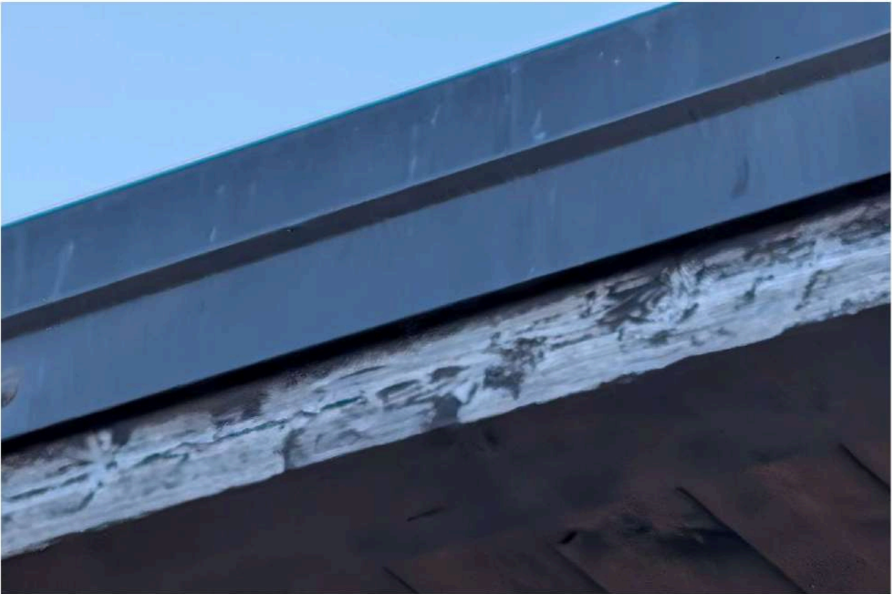
Foto n. 42 – Livello di manutenzione delle travature.
