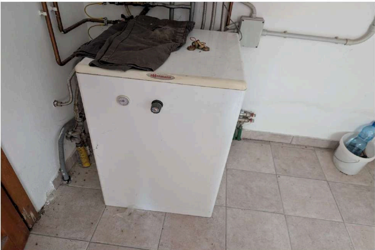
Foto n. 40 – Vaso di espansione.
