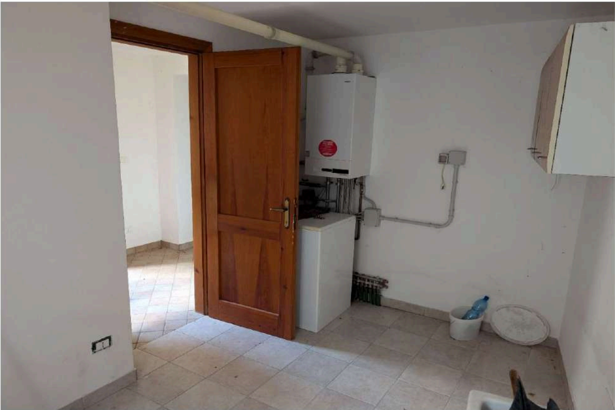
Foto n. 21 – Lavanderia – Centrale termica.
