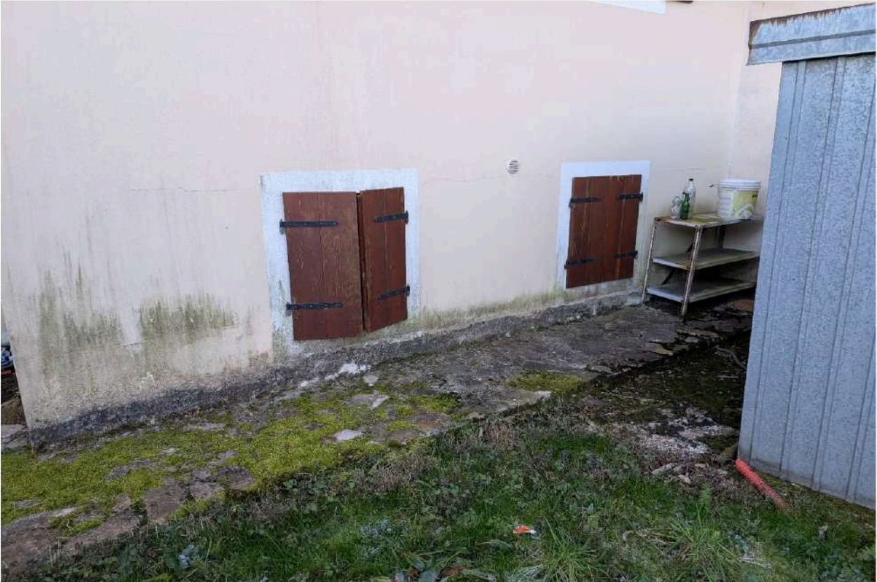
Foto n. 41 – Ammaloramento delle tinte facciata lato Nord.
