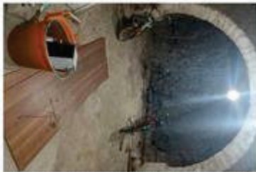
SECOLE BRACCIARE N°14 2524 R.G. DEL TRIBUNALE DI CASTROVILLARI - VISTA INTERNO GROTTA AL PIANO TERRA
