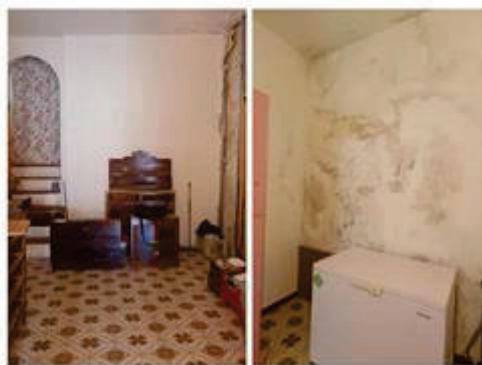
CTU ESECUZIONE IMMOBILIARE N°14/2024 R.G.E. TRIBUNALE DI CASTROVILLARI - INTERNO APPARTAMENTO AL PIANO SECONDO - INGRESSO - NOTARE INFILTRAZIONI E MACCHIE DI UMIDITA'
