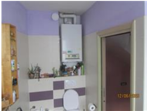
primo piano - bagno - ubicazione generatore di calore
