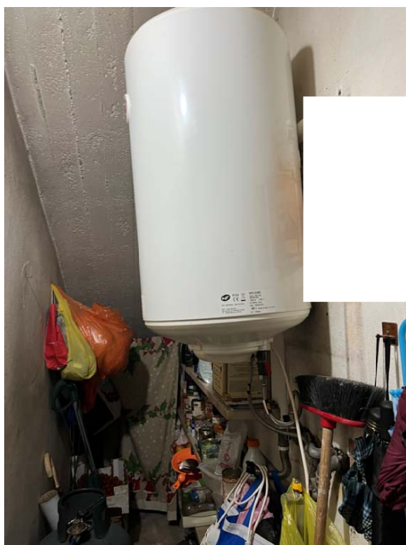
Boiler nel sottoscala
