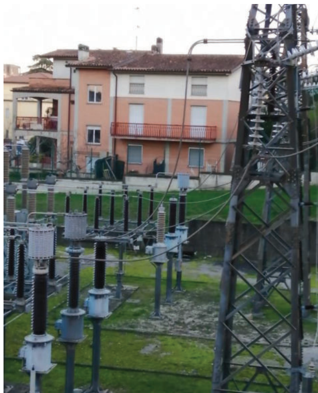
Foto 44 - PROSPETTO NORD-OVEST E TRASFORMATORI DI POTENZA
