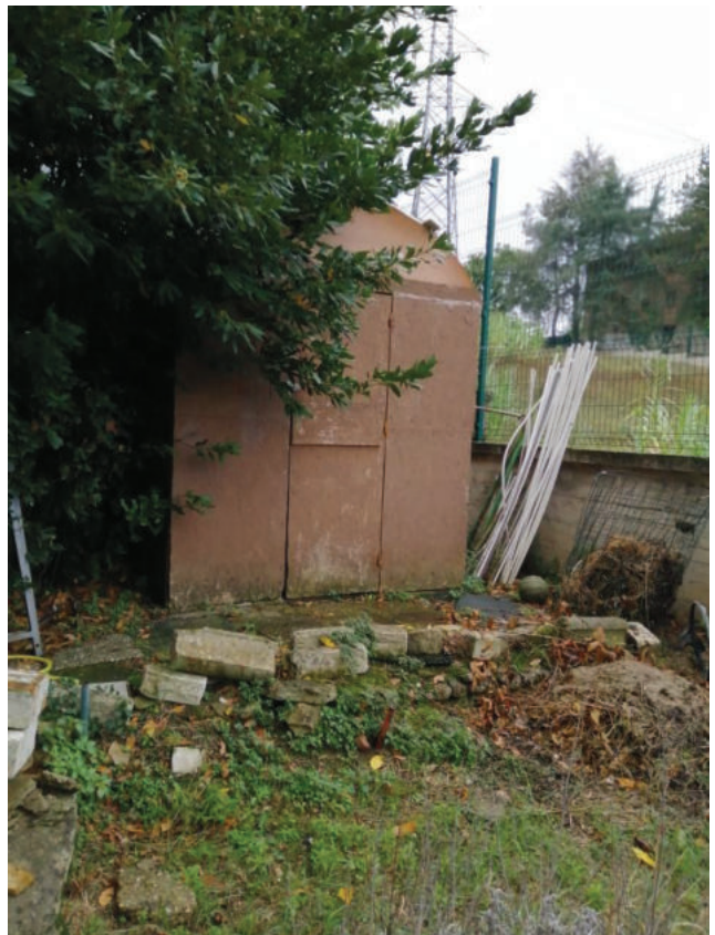
Foto 84 - RIMESSA ATTREZZI ABUSIVA
