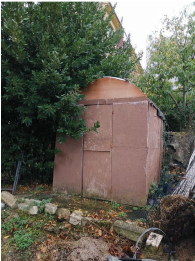
Foto 83 - RIMESSA ATTREZZI ABUSIVA
