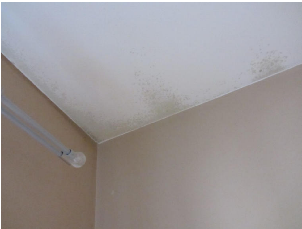
FOTO 1.25_ Umidità camera P1
