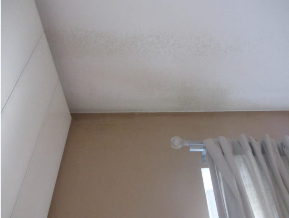
FOTO 1.24_ Umidità camera P1
