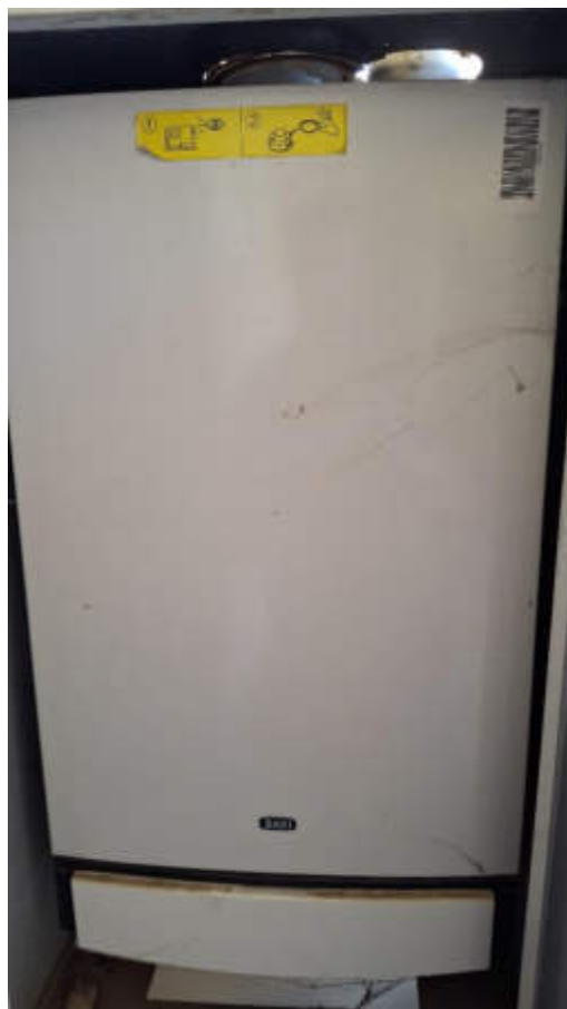
Foto 29 e 30 - veranda con accesso dalla cucina e dalla camera adiacente e caldaia riscaldamento ed acqua calda collocata nella veranda
