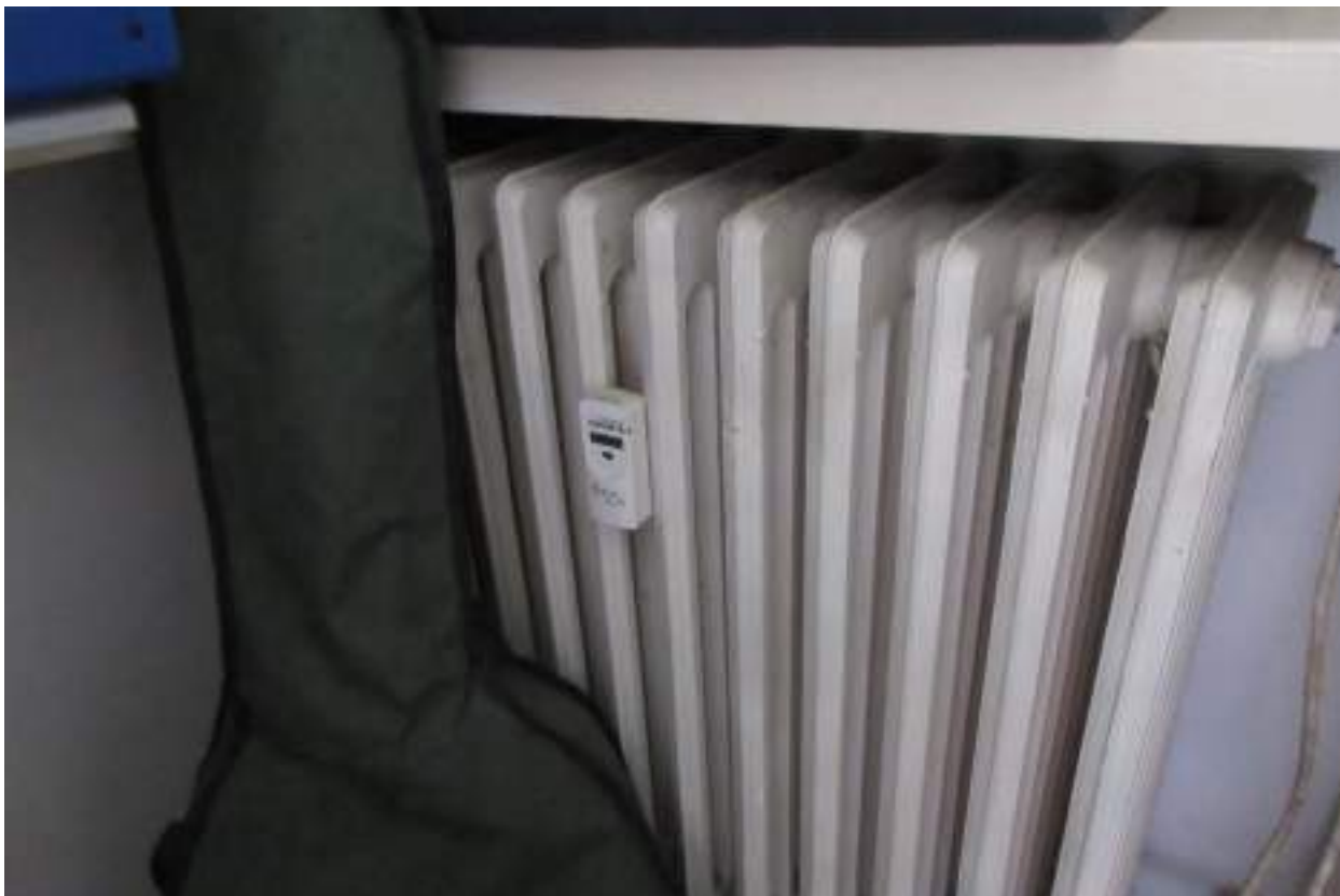
Particolare del rilevatore del calore erogato dal termosifone per la suddivisione delle spese di riscaldamento condominiale
