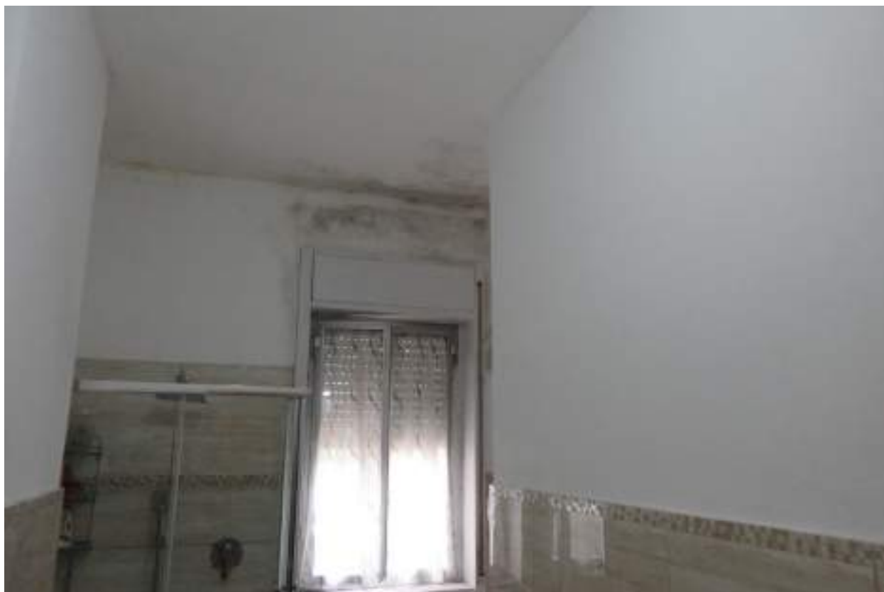
Locale bagno dove sono presenti segni di umidità
