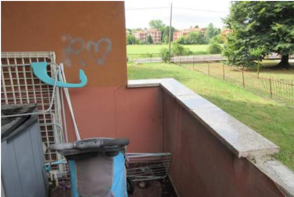
Balcone esterno con parapetto pieno in muratura in pessime condizioni di manutenzione
