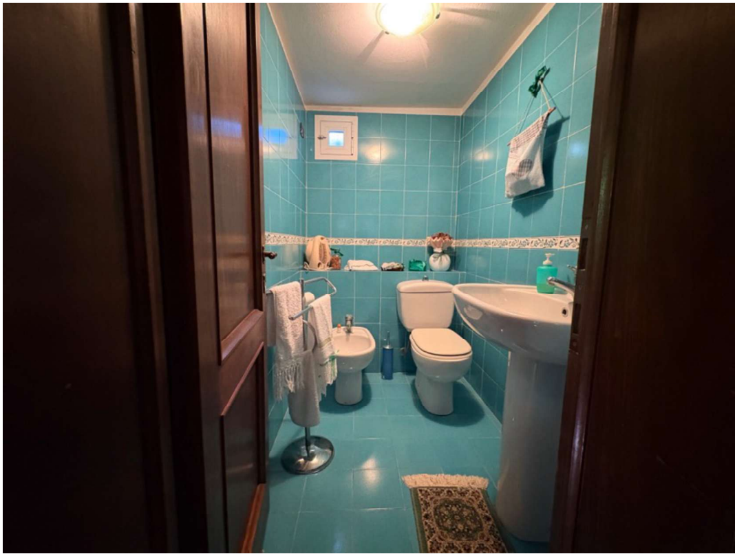
Foto 37- Bagno abusivo da demolire, piano seminterrato
