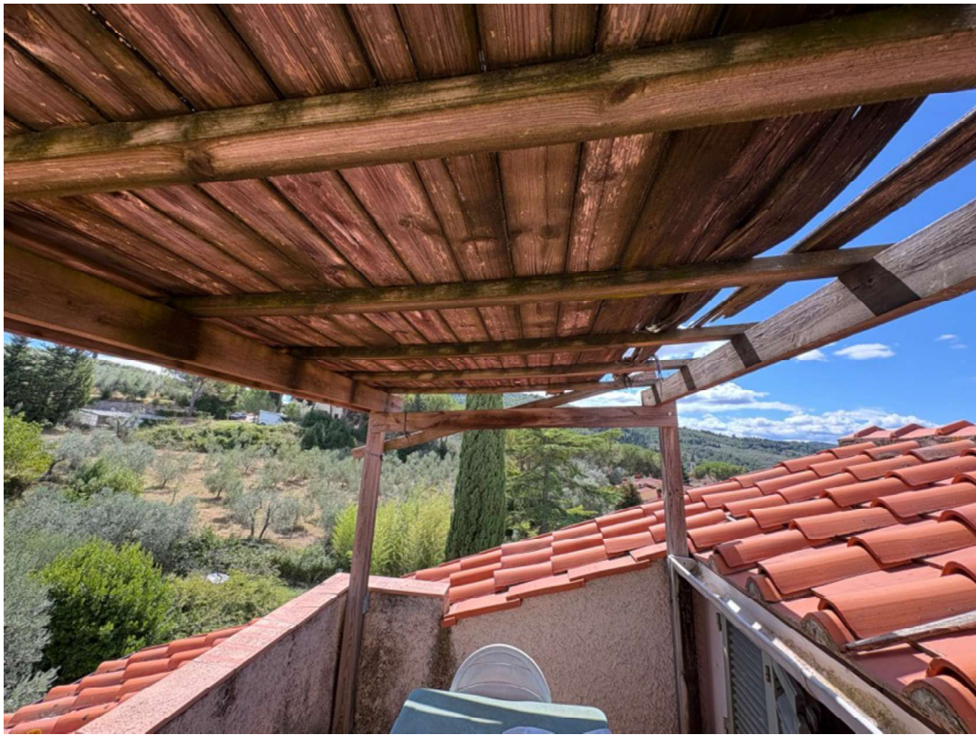
Foto 29- Terrazza a tasca, copertura abusiva da demolire
