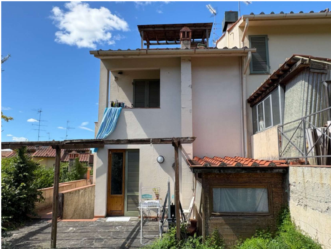
Foto 11 – Vista dal retro, ripostiglio sulla sx e copertura in legno sulla terrazza a tasca abusive, da demolire
