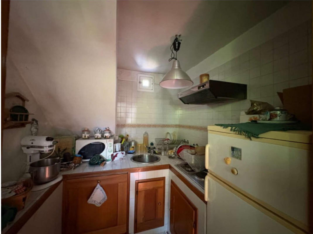
Foto 36 – Cucina abusiva da demolire, piano seminterrato
