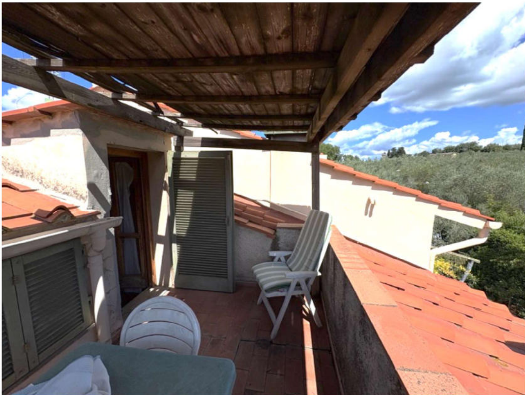
Foto 28 -Terrazza a tasca, copertura abusiva da demolire
