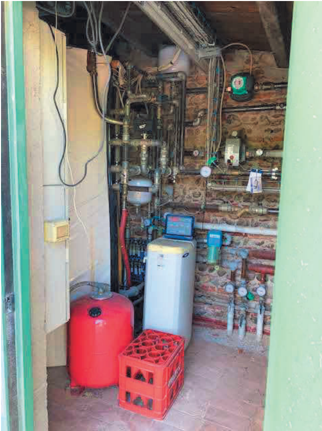
LOCALE CALDAIA (accesso da esterno)
