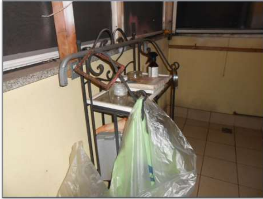
Foto 13 balcone 2 chiuso abusivamente
