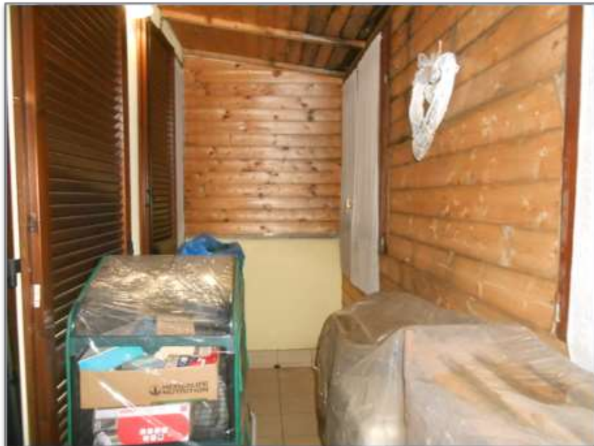
Foto 14 balcone 3 chiuso abusivamente
