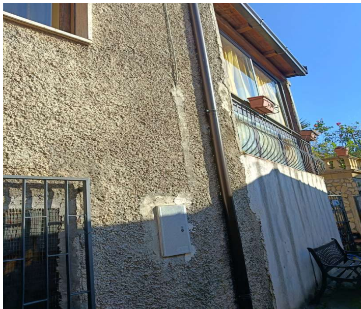
Figura 3) - ESTERNO DEL FABBRICATO
