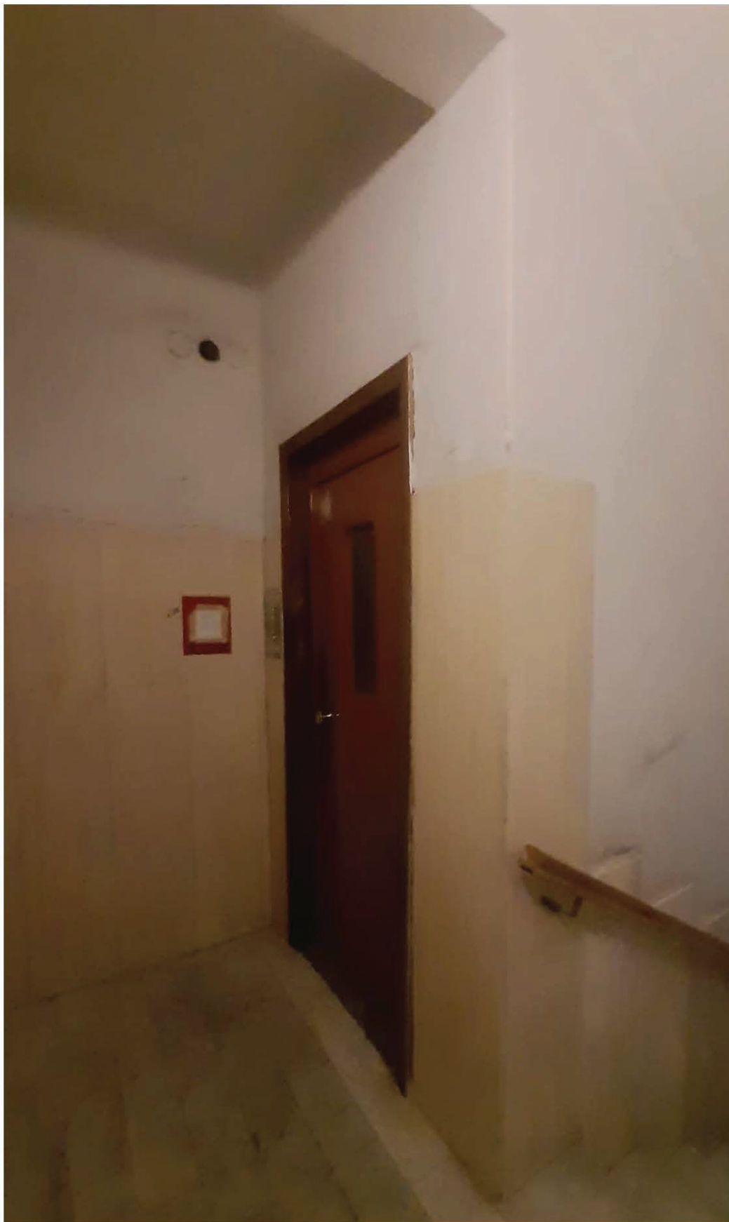
Foto n 6: Corpo ascensore
