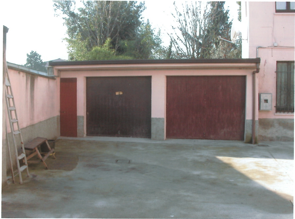
Foto n°13: Via XXV Maggio n°45 - Corpo interno di fabbricato box e ripostiglio. Realizzati su precedente magazzino di cui al mappale 60 sub. 3 e 5 demolito; ricostruito senza licenza edilizia e non censito.
