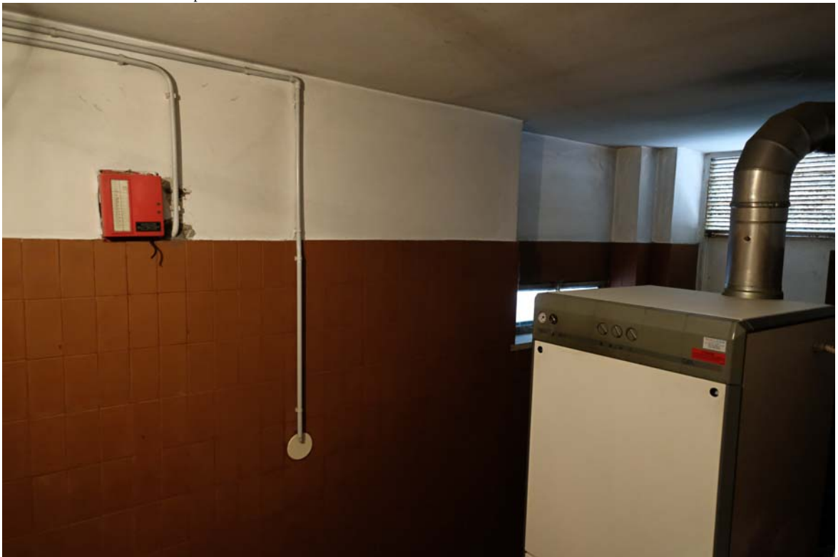
caldaia piano sottostrada Villa Via Pierpaoli
