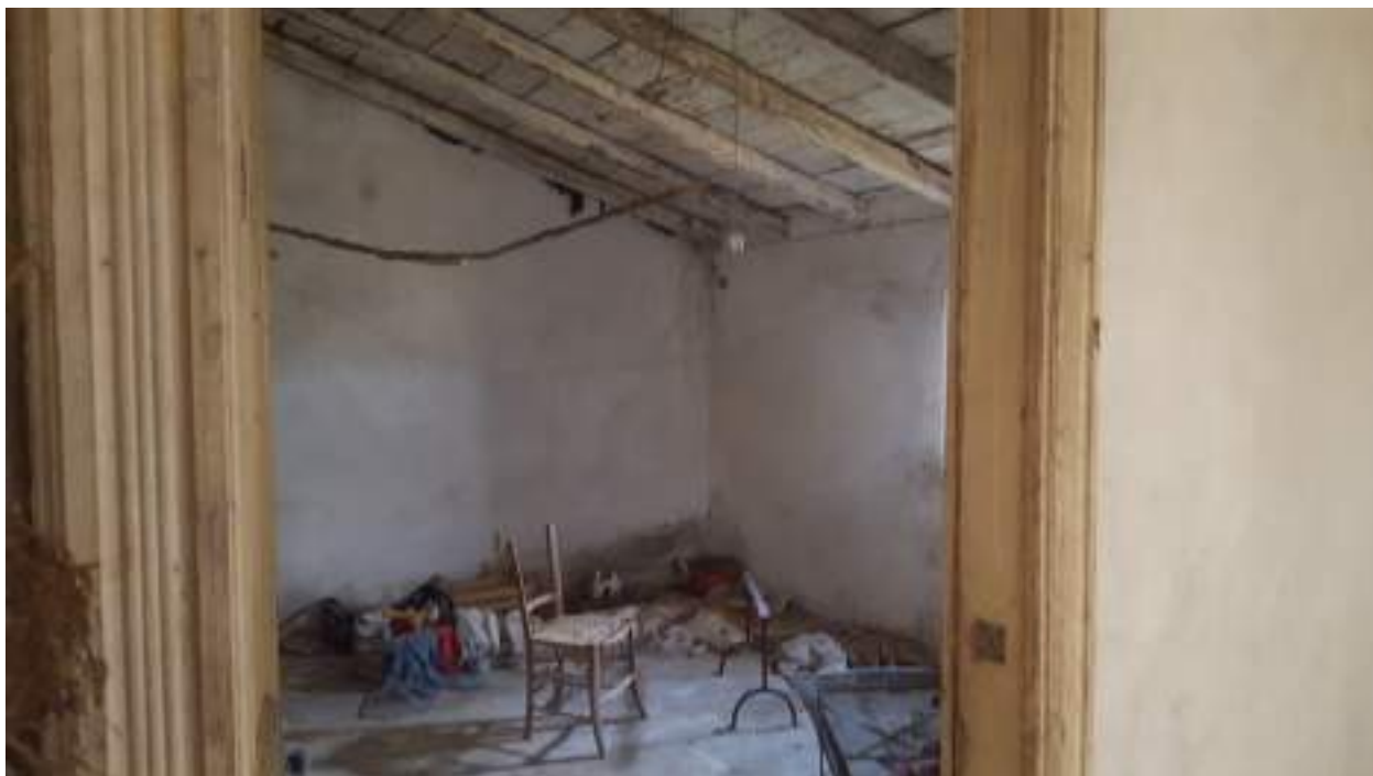
FOTO N. 12 – IMMOBILE N. 1 - FONDO C.DA S.IPPOLITO – FABBRICATO PART. 19 - VANO
