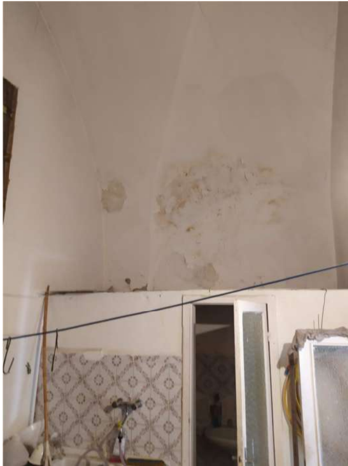
Foto 7 _ Lotto n. 1 _ Zona w.c., macchie umidità sulla volta
