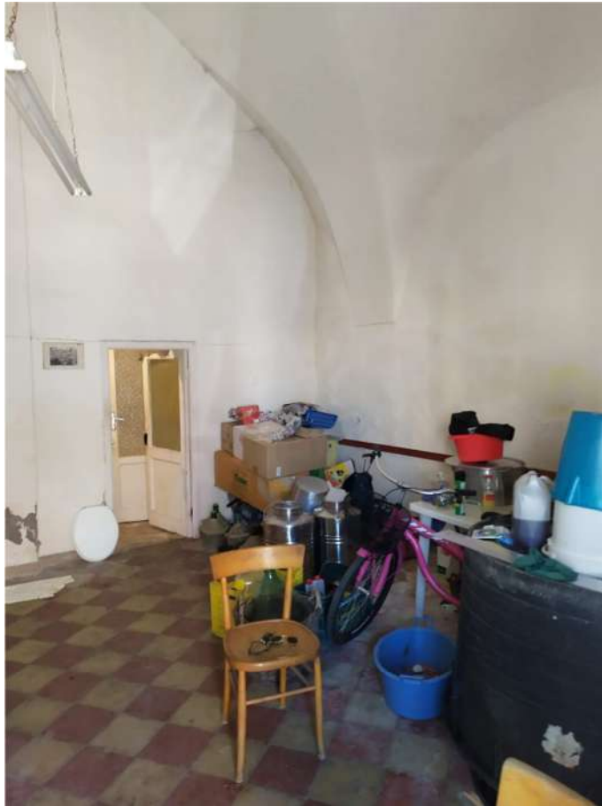
Foto 5 _ Lotto n.1 _ pavimento e segni di umidità sulle pareti
