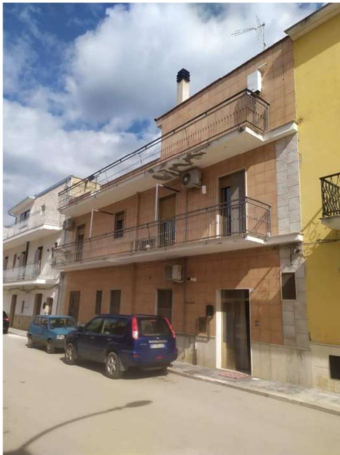
Foto 10 _ Lotto n. 2 _ Facciata su Via Manin _ Soletta balcone a secondo piano interessata da infiltrazioni
