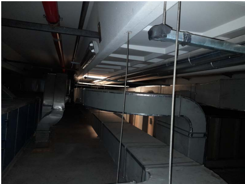
Foto 16 Locale Macchine (UTA) al Piano Primo
