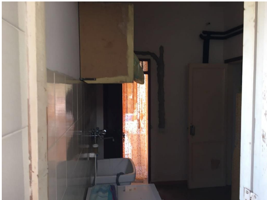
Foton.51 - Locale caldaia (Corpo A cat.D/7 - piano terra)
