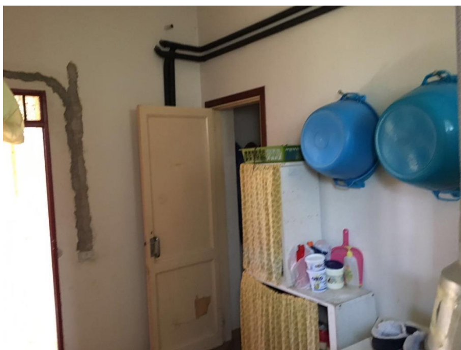
Foton.52 - Locale caldaia (Corpo A cat.D/7 - piano terra)
