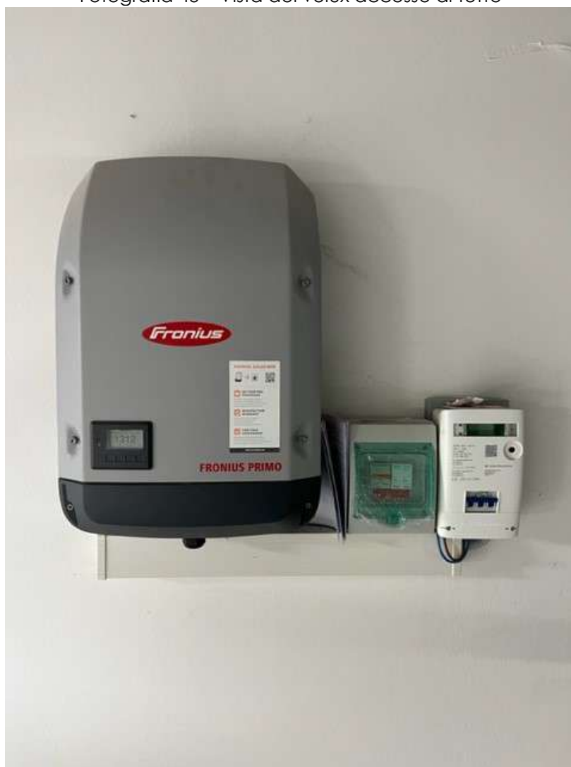
Fotografia 44– Vista impianti fotovoltaico
