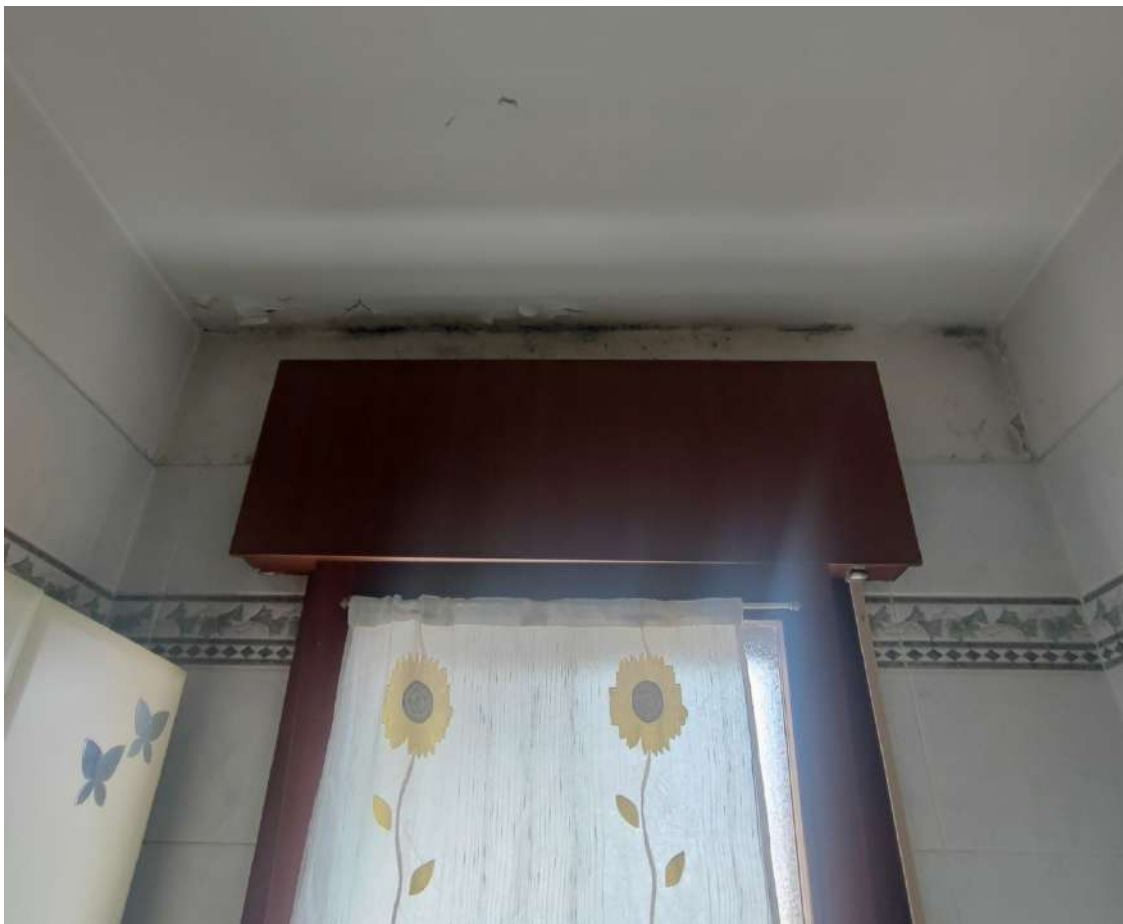
Fotografia n. 25 – Appartamento P. 3 – Muffe tra parete e soffitto (lato Nord-Est)
