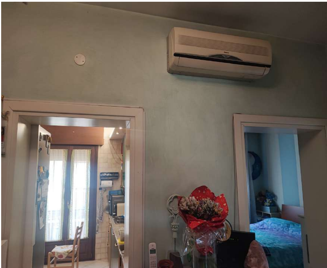
Fotografia n. 16 – Appartamento P. 3 – Ingresso con split per raffreddamento
