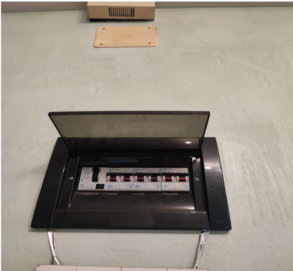
Fotografia n. 12 – Appartamento P. 3 – Dispositivi interni
