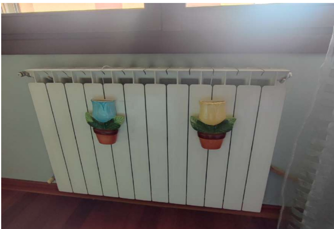
Fotografia n. 20 – Appartamento P. 3 – Termosifoni
