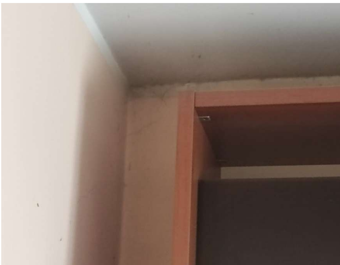
Fotografia n. 26 – Appartamento P. 3 – Muffe tra parete e soffitto (lato Nord-Est)
