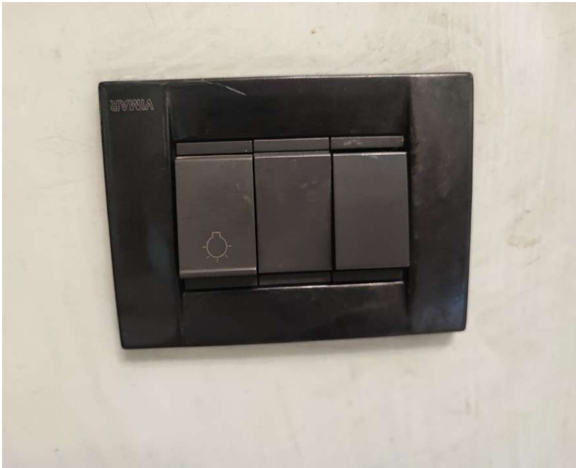
Fotografia n. 13 – Appartamento P. 3 – Dispositivi interni
