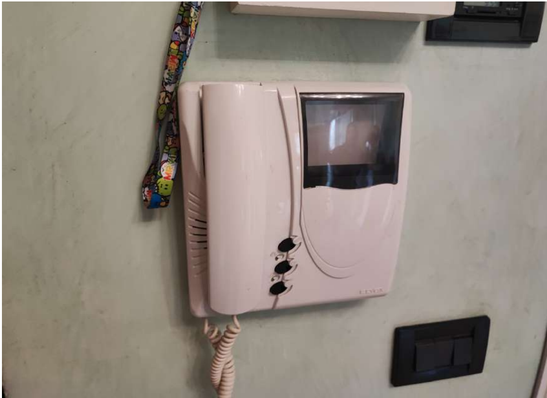
Fotografia n. 11 – Appartamento P. 3 – Dispositivi interni
