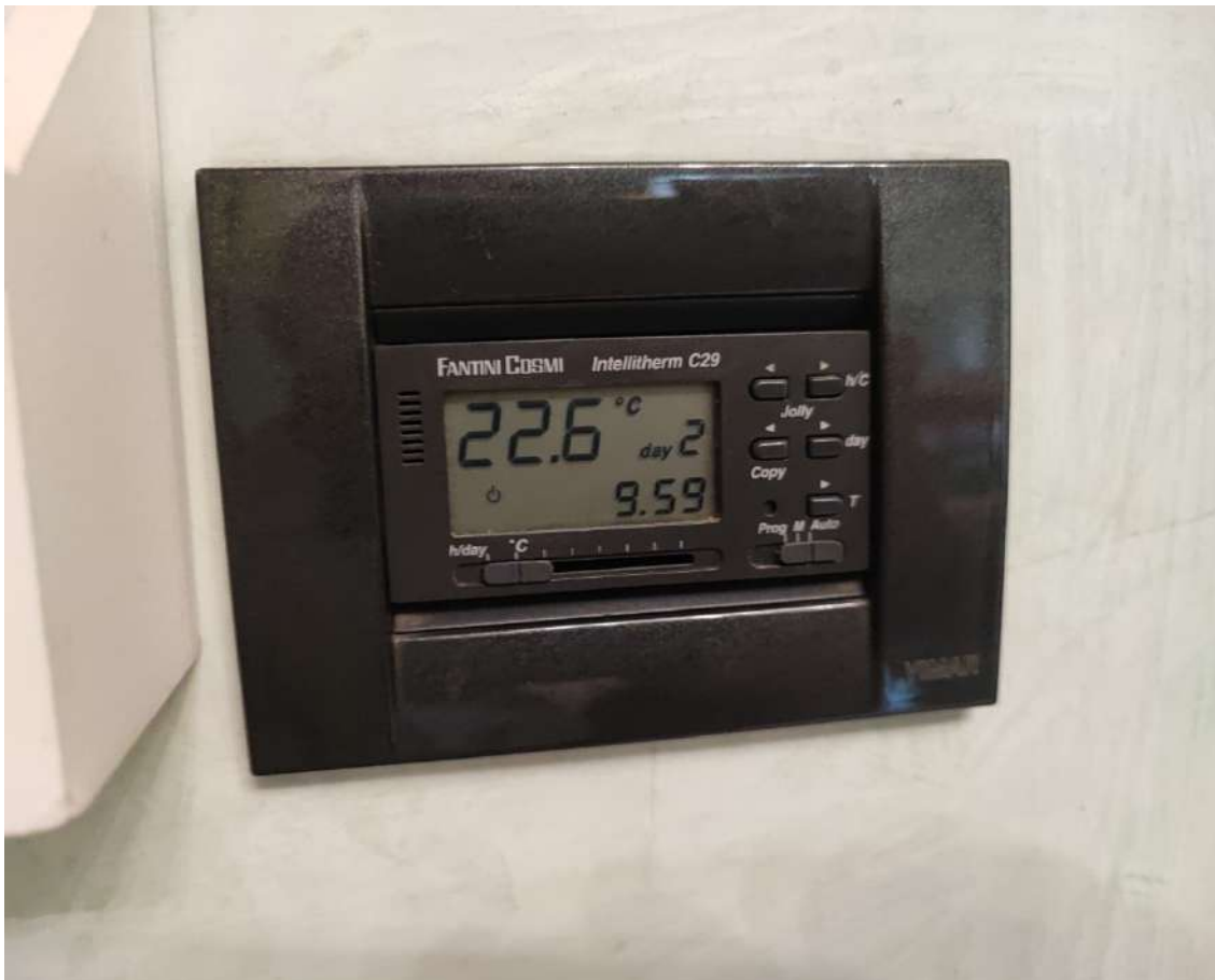
Fotografia n. 14 – Appartamento P. 3 – Dispositivi interni
