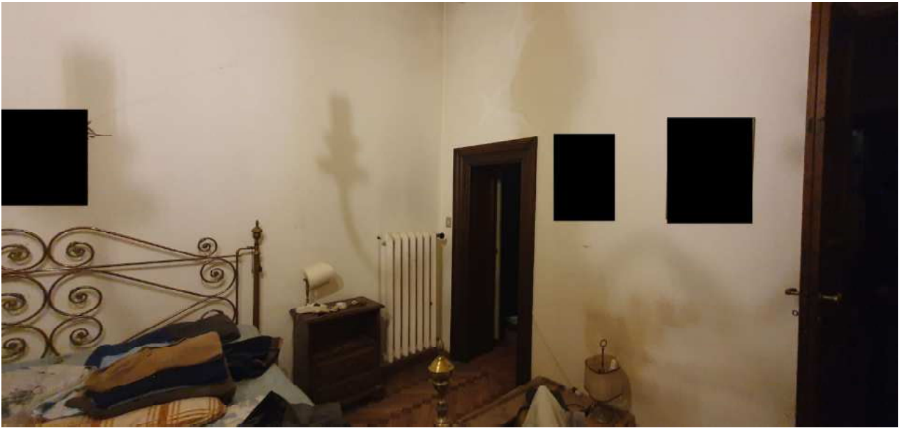
FOTO 21 – Ripresa fotografica della camera padronale con la presenza di varco non dichiarato che porta al disimpegno dei servizi igienici
