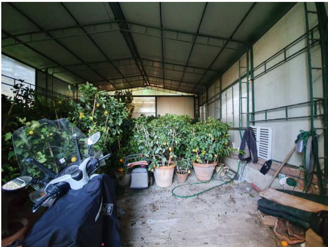
FOTO 26 – Ripresa fotografica deposito senza titolo edilizio ed oggetto di ordinanza di demolizione
