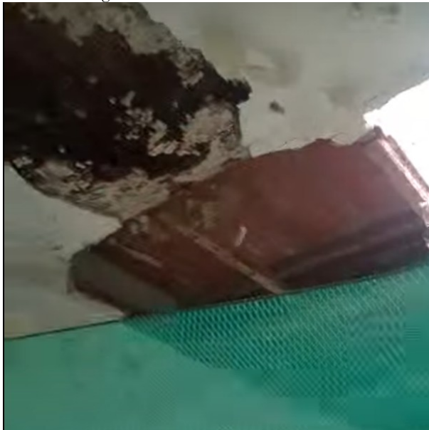
Foto n. 3 - Degrado del soffitto del vano scala H
