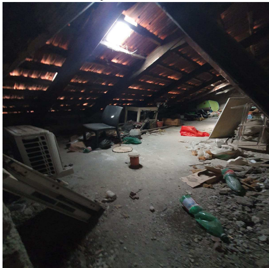
Foto n. 11 – Beni depositati all'interno del sub. 221
