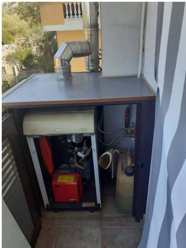
Foto n. 27 – Caldaia nella veranda della cucina / pranzo
