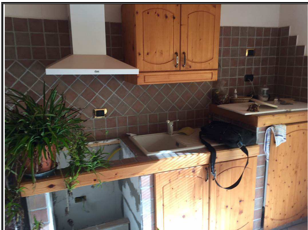
Foto n. 14 Locale del piano terra per il quale è stato realizzato abusivamente il cambio d'uso.
