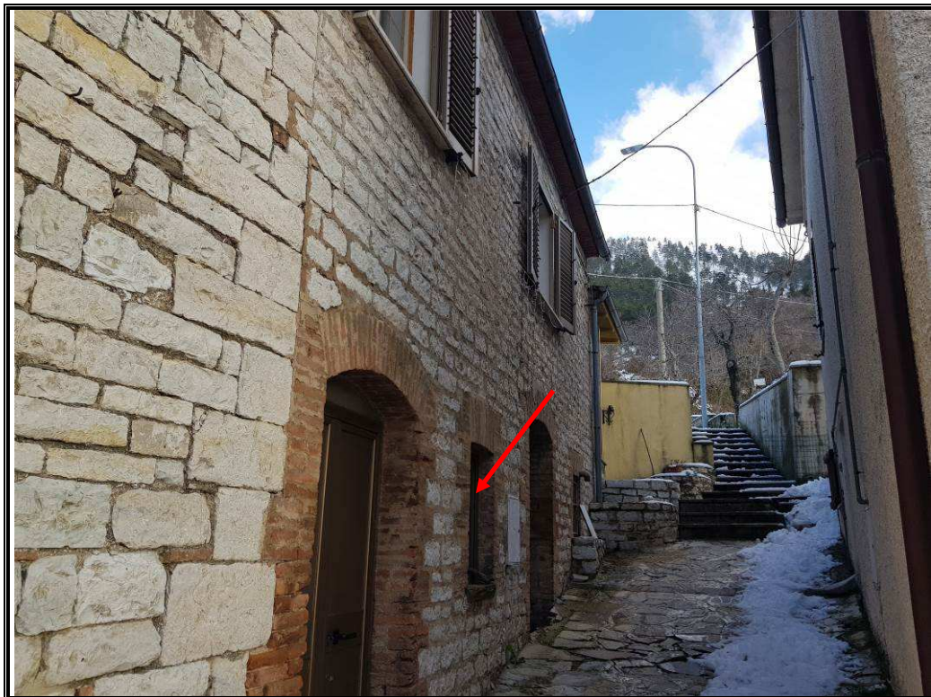
Foto n. 3 Vista del fabbricato abitativo. La freccia evidenzia la finestra realizzata abusivamente.
