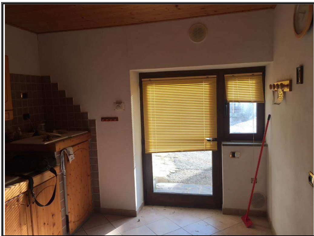
Foto n. 13 Locale del piano terra per il quale è stato realizzato abusivamente il cambio d'uso.
