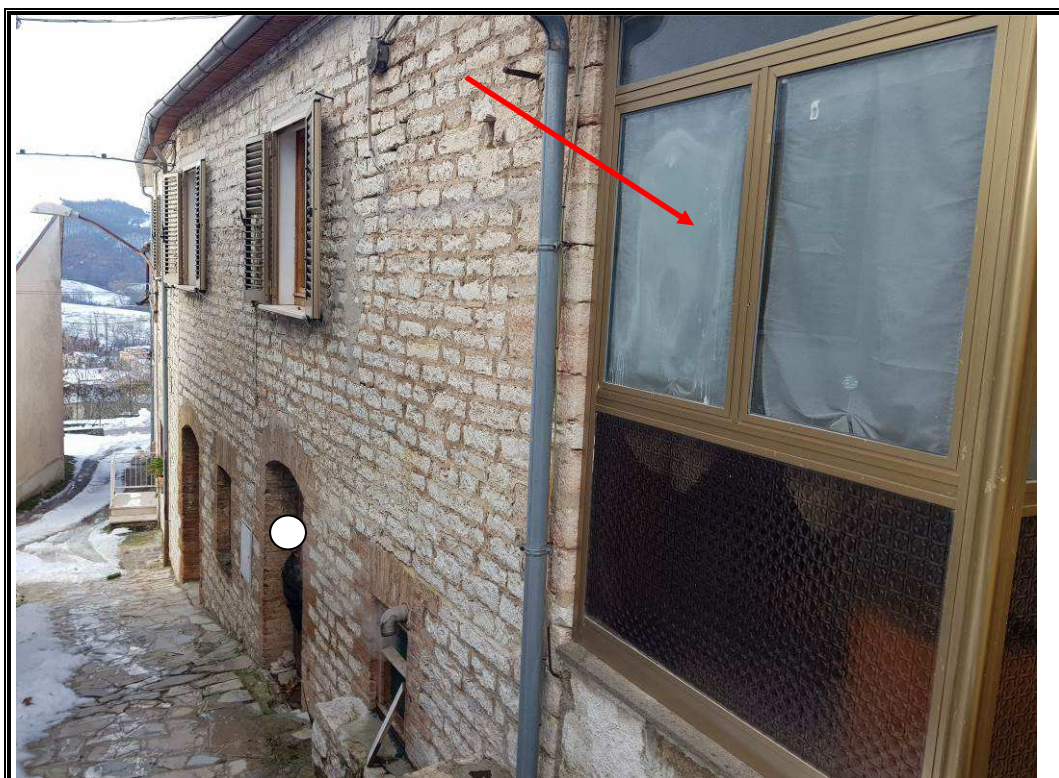
Foto n. 4 Vista del fabbricato abitativo con, in primo piano, il manufatto abusivo da demolire.
