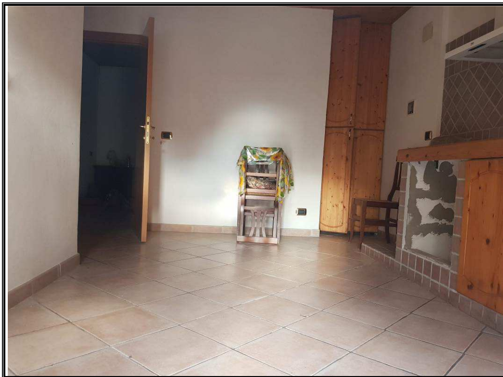
Foto n. 11 Locale del piano terra per il quale è stato realizzato abusivamente il cambio d'uso.
