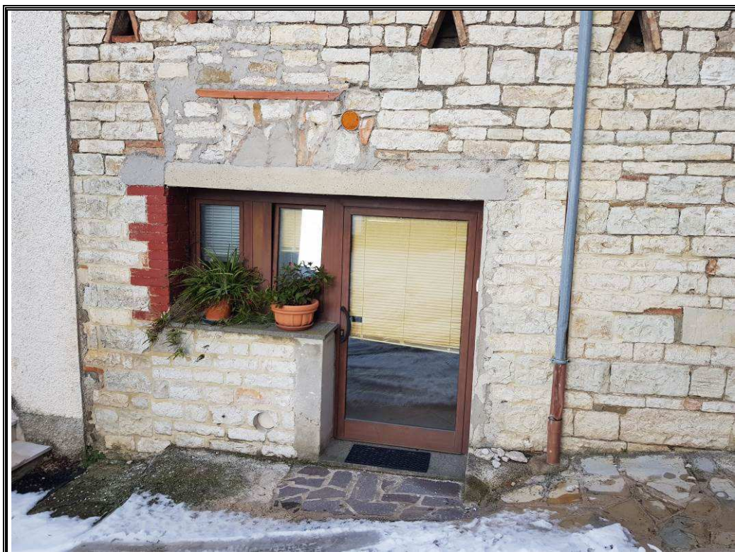
Foto n. 10 Vista dell'ingresso al locale del piano terra per il quale è stato realizzato abusivamente il cambio d'uso.
